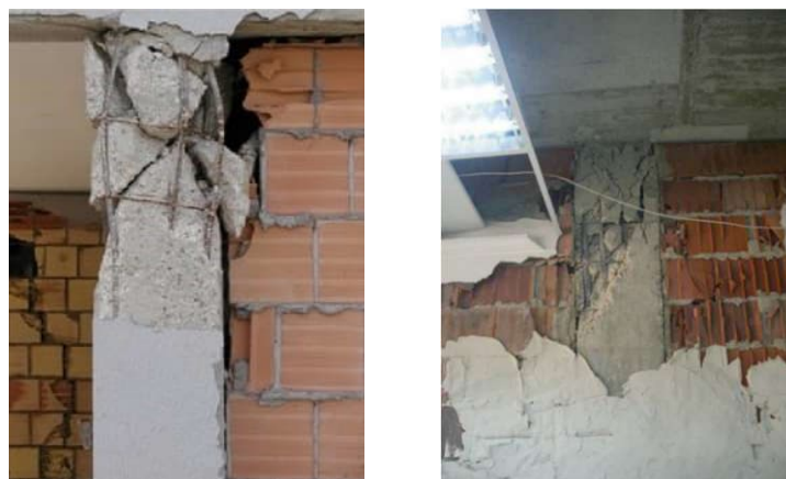
Abb. 10: Lokalversagen an Einleitungsstelle des diagonalen Druckstabes nach Molise Erdbeben 2002 [13] (links); Lorca Erdbeben 2011 [38] (rechts)
