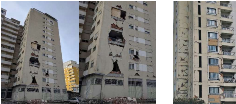
Abb. 9: Schäden an Mauerwerksausfachungen nach Albanien Erdbeben 2019 [36] (links); Nepal Erdbeben 2015 [37] (rechts)
