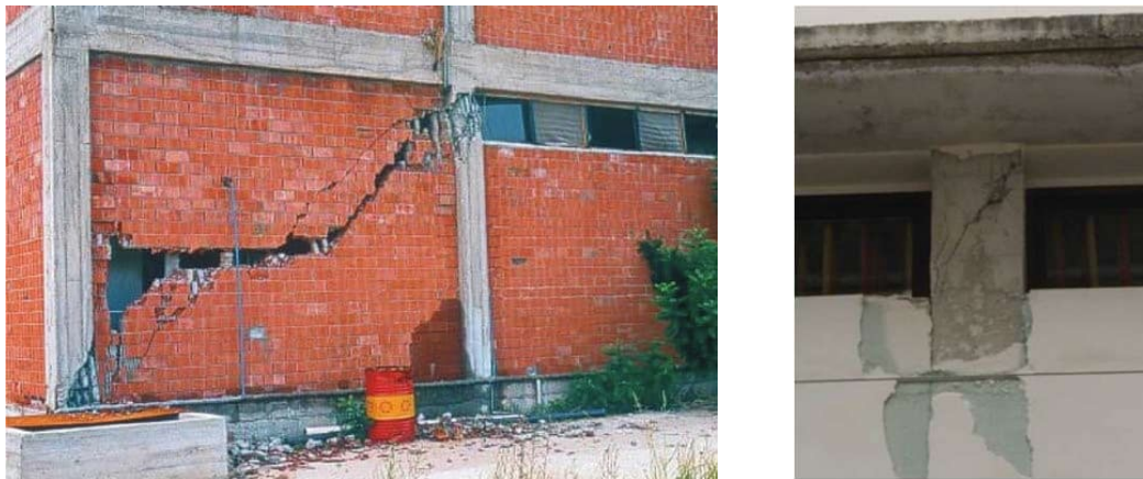
Abb. 11: Versagen kurzer Stützen aufgrund konstruktiv ungünstiger Durchbildung nach Adana-Ceyhan Erdbeben 1998 [13] (links); Lorca Erdbeben 2011 [38] (rechts)
