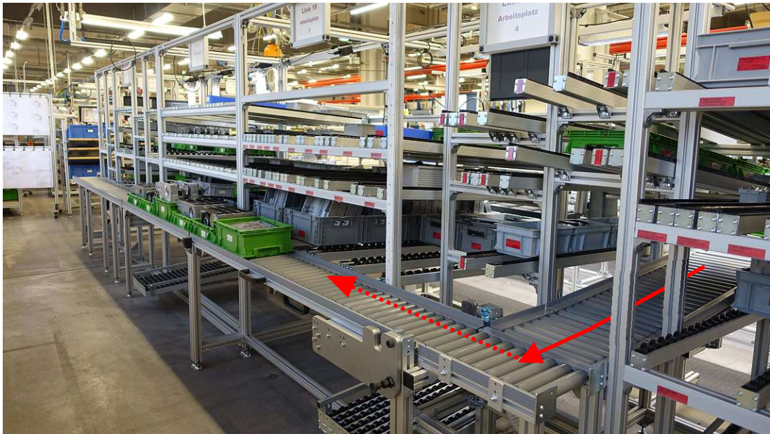
(a) Umlenken der Behälter auf die querlaufende Rollenbahn
