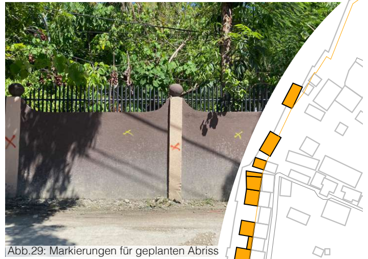
Abb.29: Markierungen für geplanten Abriss
