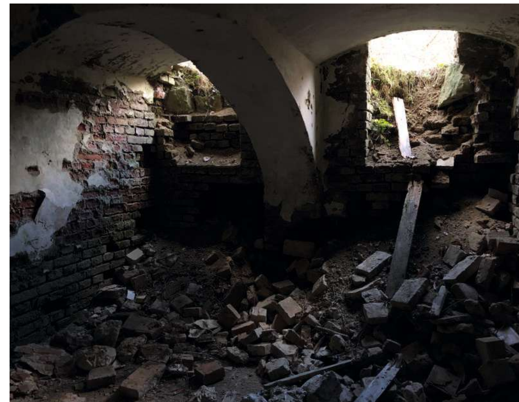
o. Vandalismus in den Zimmern im Obergeschoss u. Teilweise eingefallenes Mauerwerk im Keller
