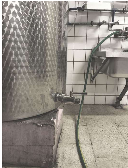
Abb. 43: Immervolltank auf EPS-Sockel
