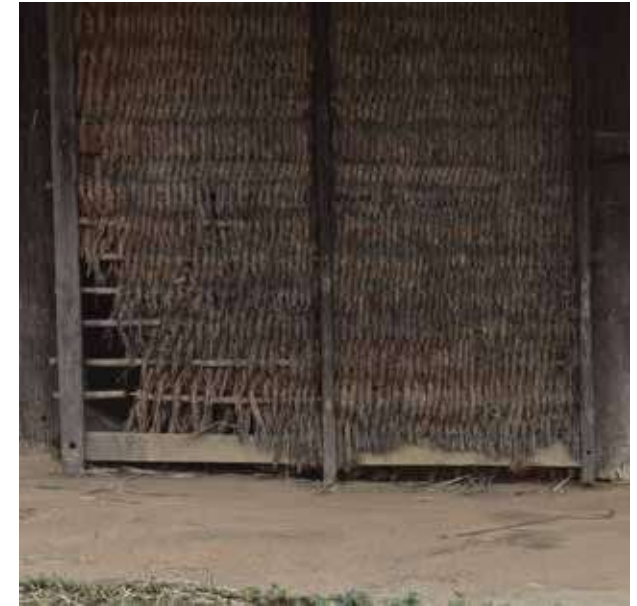
Abb. 142: Durch die Schäden wird die Konstruktion unter den gedrehten Strohzöpfen sichtbar
