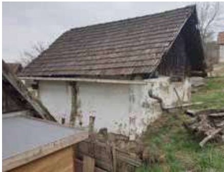
Abb. 156: Die Balkenköpfe müssen ordnungsgemäß verputzt werden, um Schäden am Holz zu verhindern
