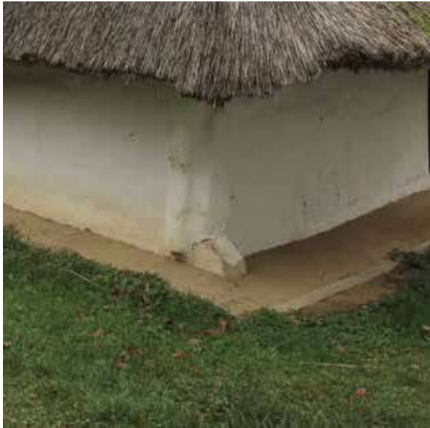
Abb. 116: Deutlich vorstehender Schwellenkranz
