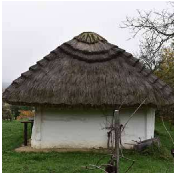
Abb. 133: Für ein Strohdach nicht geeignete Dachneigung
