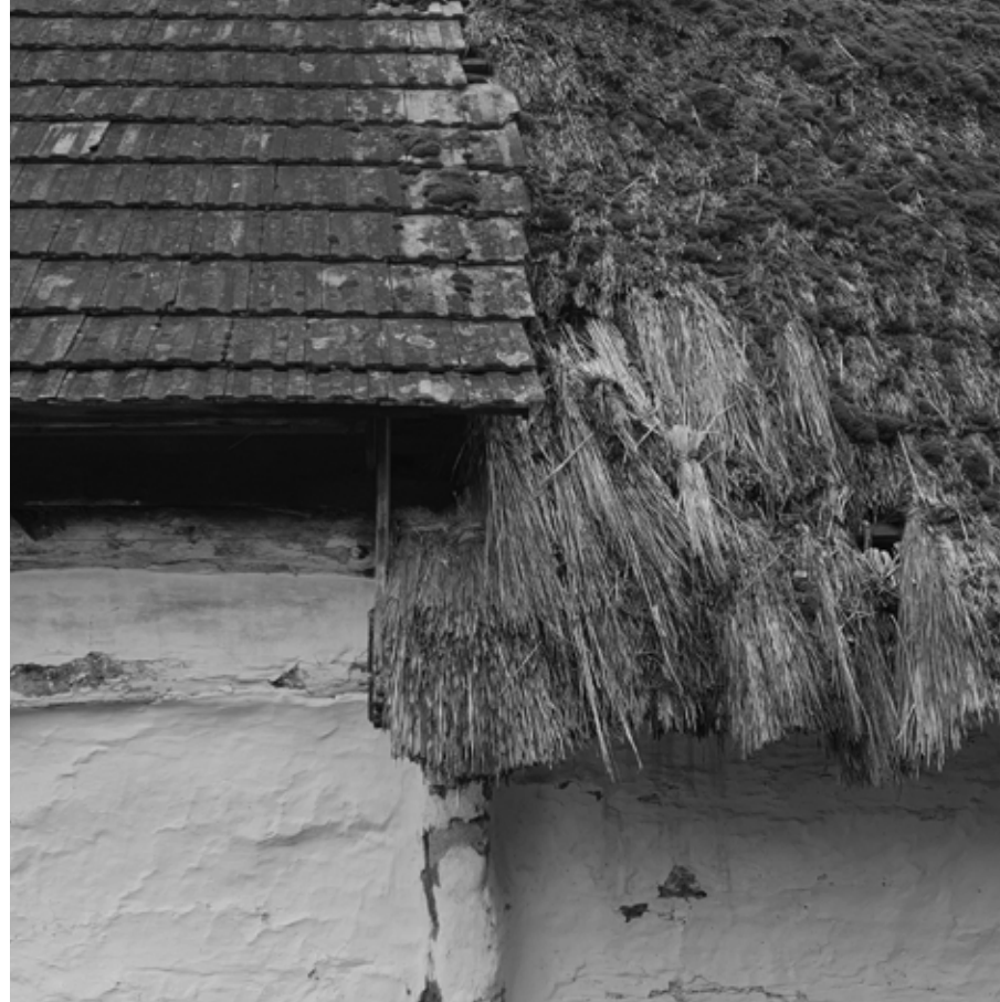
Abb. 30: Materialübergang, Objekt 130. Die unterschiedlichen Dächer lassen auf verschiedene Besitzer schließen
