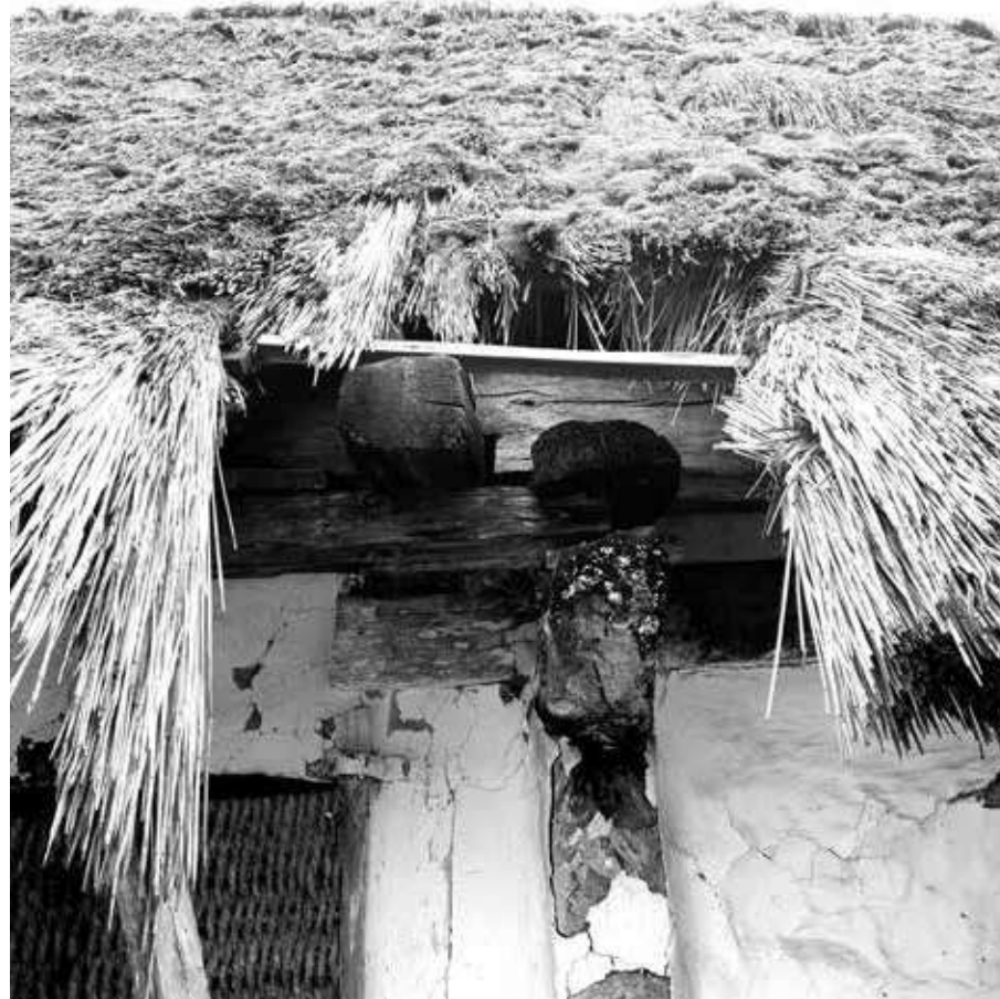
Abb. 149: Schäden am Strohdach des Objektes 130
