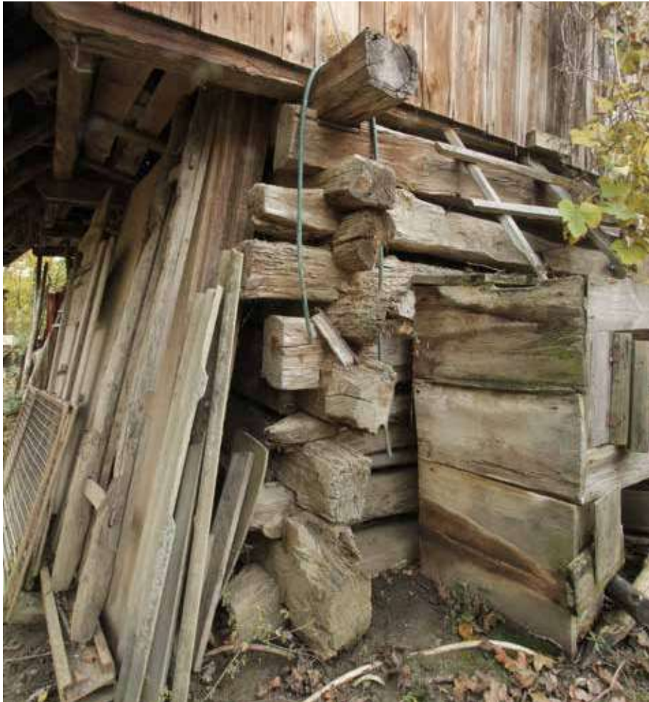
Abb. 114: Unregelmäßige Wettköpfe am Objekt 12
