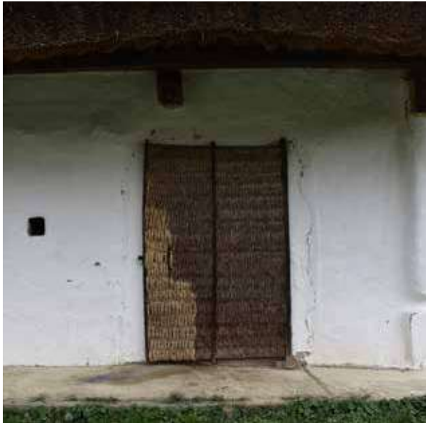
Abb. 140: Sichtbare Ausbesserung an einer Strohtüre
