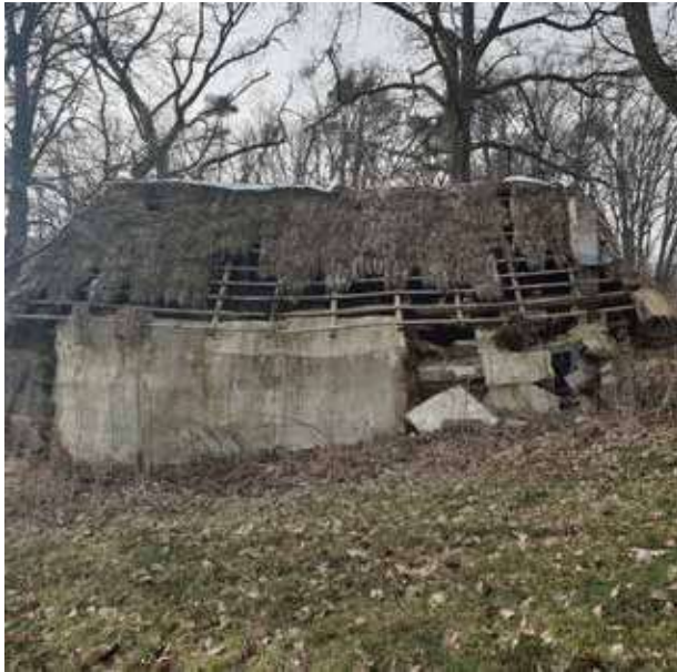
Abb. 150: Ein Teil der Rückwand des Objektes 111 (unter Denkmalschutz) ist bereits eingebrochen, das Dach ist nicht mehr funktionstüchtig
