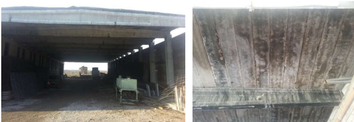
Abbildung 89: Vorderansicht der Maschinenhalle – eine Stahlbetontragkonstruktion wird mit Tarolitplatten an den Wänden und auf der Decke „aufgefüllt“
