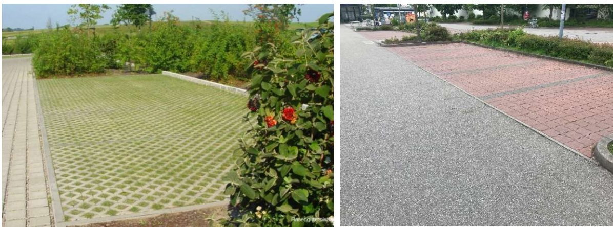
Abb. 44: Parkplatz mit Rasengittersteinen (links; \psi_m = 0,15 (siehe Abb. 43)) und Parkplatz mit Pflaster mit dichten Fugen (rechts; \psi_m = 0,75 (siehe Abb. 43)) (Bild rechts: Eigene Darstellung, Bild links: (EHL AG o.J.))
