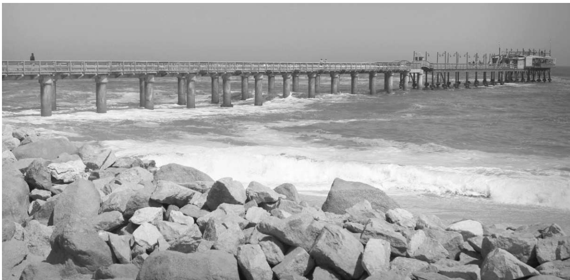
Abb. 66: Die Jetty im Jahr 2019: Nur mehr der Brückenkopf ist im originalen Zustand erhalten geblieben.
