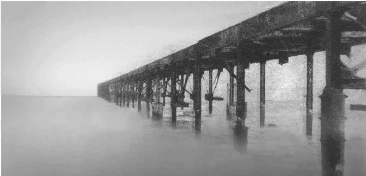
Abb. 50: Rein äußerlich betrachtet schien die Brücke dem Tode geweiht - doch der Eindruck täuscht.
