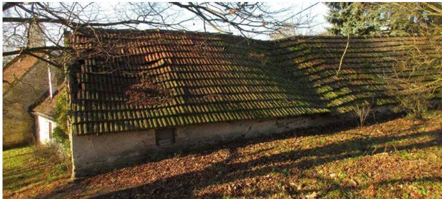
Abb. 3.27 | Schäden der Dachhaut
