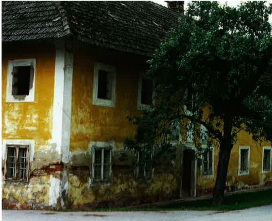
Abb. 3.08 | Bauschäden an den Außenwänden des Liningergutes
