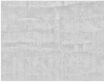
Decke Lackiererei Beton
