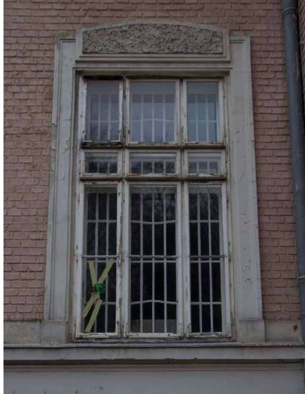
Abb. 73: Fenster sind gut erhalten, benötigen aber eine Sanierung
