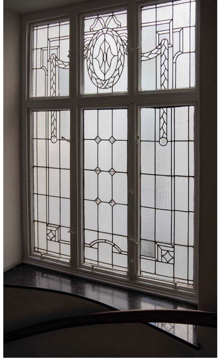
Abb 4.69 1030 Wien, stilisierter Laubkranz, geprägtes Glas mit Prismen, errichtet 1911
