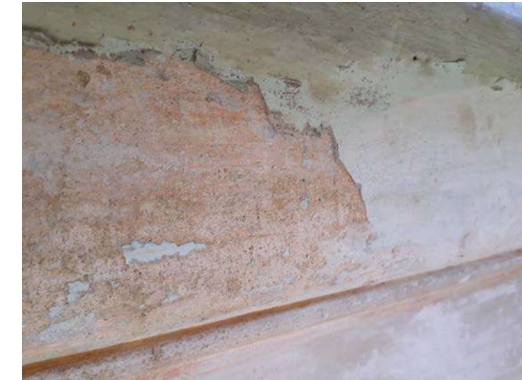
Abb. 214: Oberer Fassadenabschluss mit verschiedenen Farbschichten.
