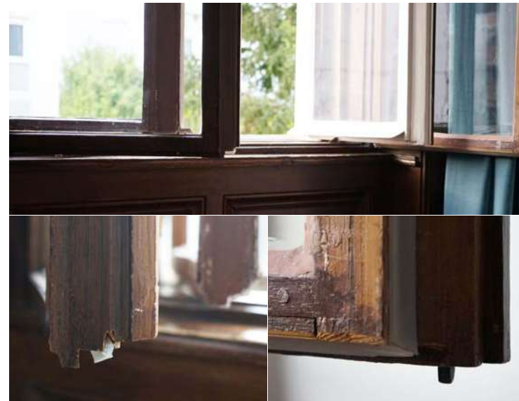
Abb. 264: Obergeschoß Detail eines sanierten Fensters mit eingefrästen Dichtungen an den Innenflügeln, Innenflügel unverändert, Außenflügel außen neu gestrichen.
