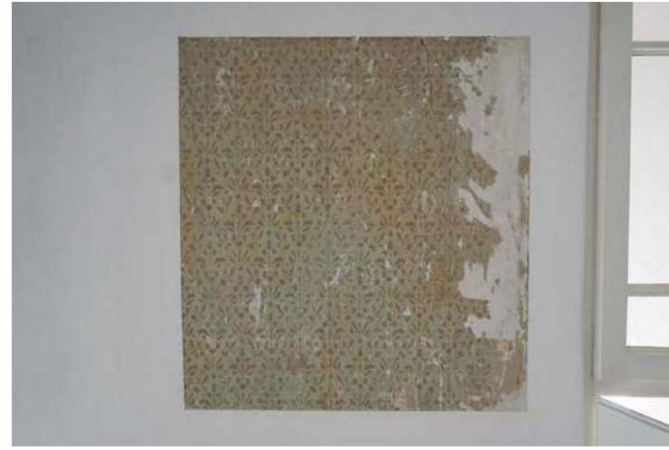
Abb. 274: „Zeitfenster“, un- behandelte Wandfläche im Vorraum im Obergeschoß.
