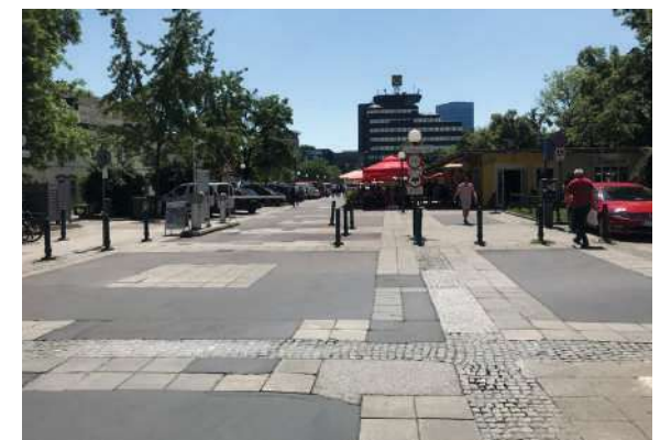
Schäden an der Pflasterung
