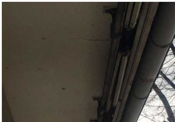
Risse in der Auskragung des Daches
