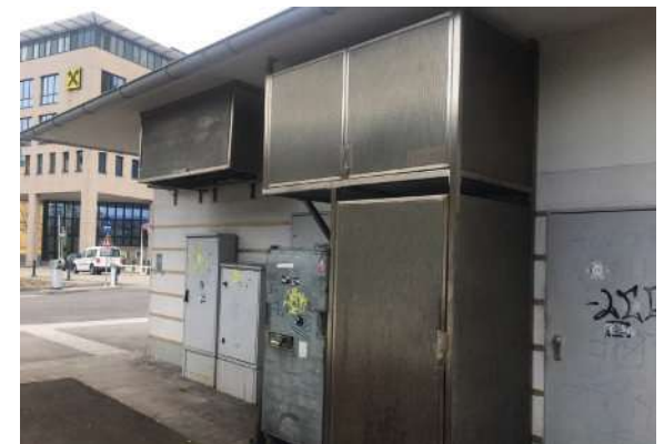
Klimaanlagen und Kühlcontainer an der Außenseite
