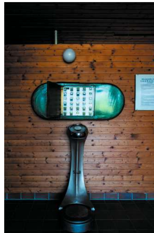
Abb. 46 – Originale Einbauten, Sicherungskasten im typischen Grün mit Körperwaage. Ausgang Saunabereich
