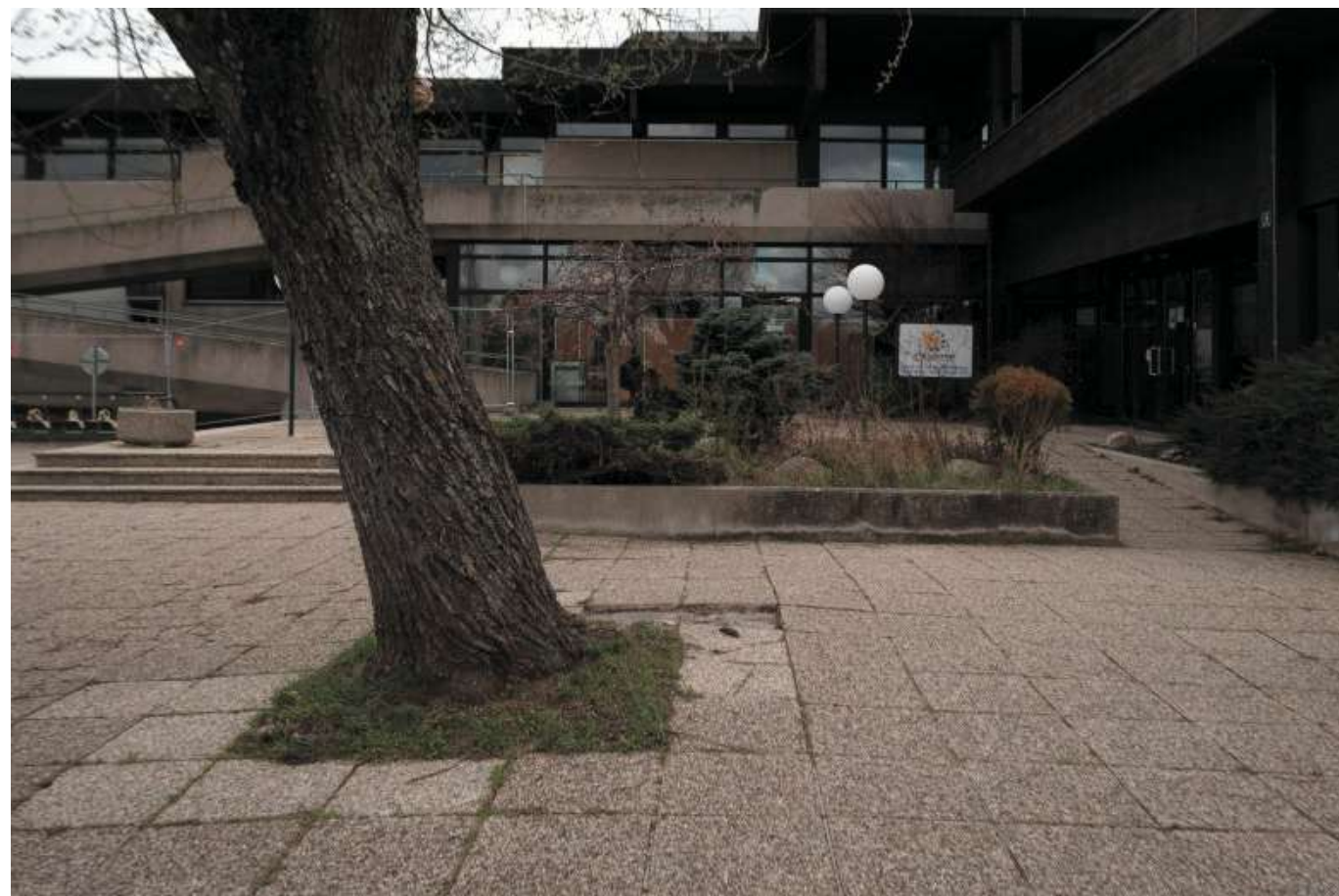
Abb. 106 – Vorplatz mit Schäden durch den Wurzelwuchs des Baumes
