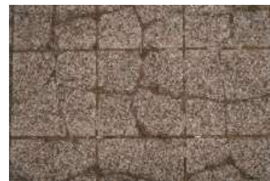
172 Abb. 101 – Schadhafte Bodenplatten
