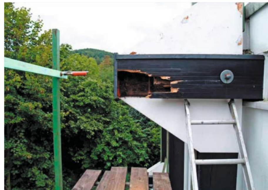
Abb. 82 – Haus Mayer Kuckuk: Schadensbild des von Innen nach Außen, durch Braunftäule zerstörten Trägers
