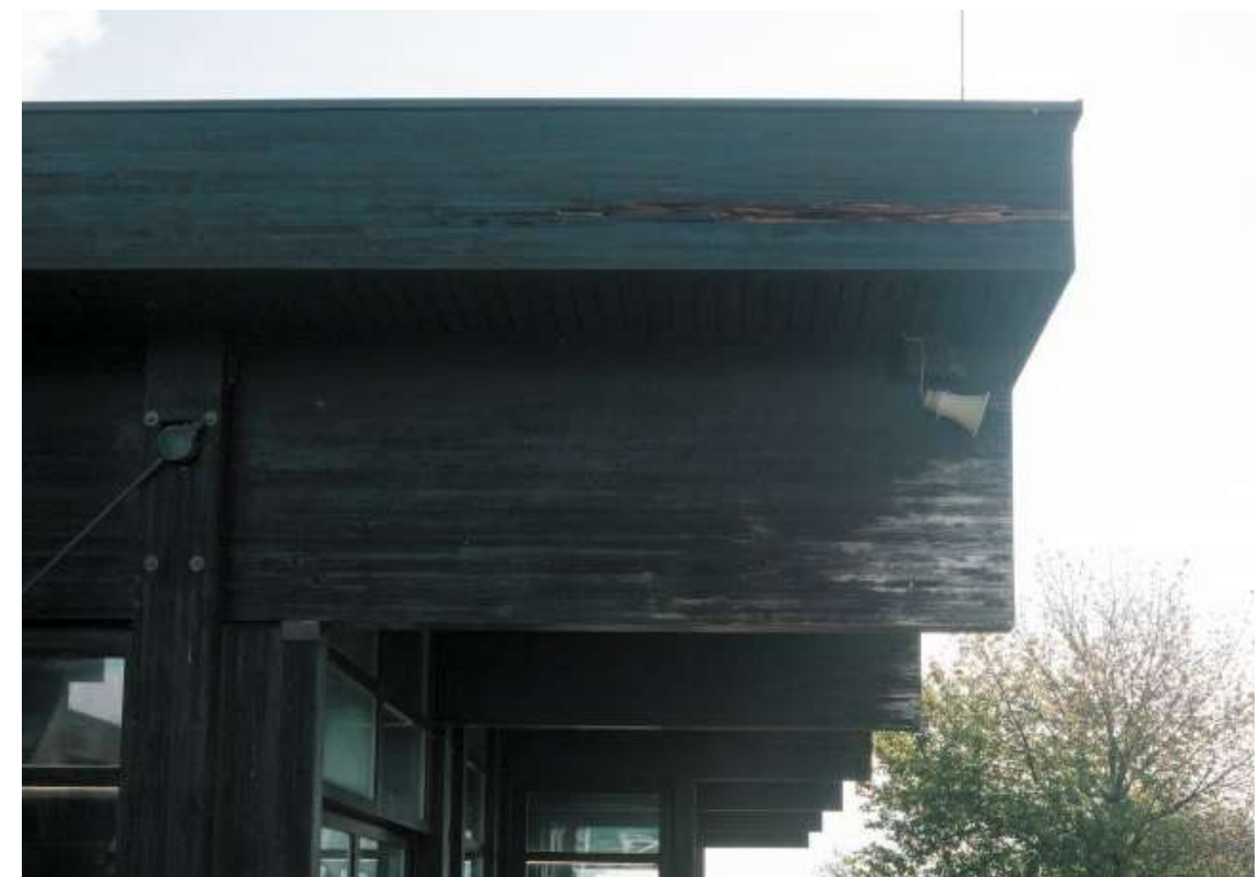
Abb. 99 – Von Fäulnis betroffene Attika im Außenbereich des Lehrschwimmbekens, 2019
