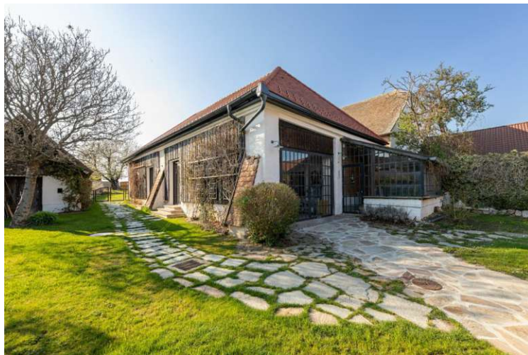
Abb. 131: Fertiggestellter Umbau der Scheune (Quelle: Amt der NÖ Landesregierung – Gruppe Baudirektion 2023b)
