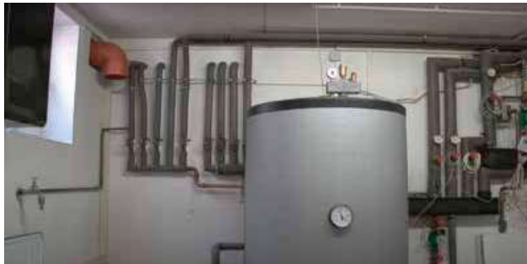
Abb.21 - übergabestation mit warmwasserspeicher
