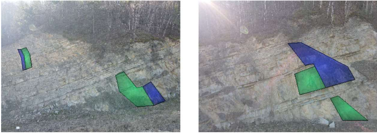
Abb. 7.9: Trennflächen über mehrere Schichtungen des linken und rechten Wandteils, Nordost-Südwest (grün) und Nord (blau)
