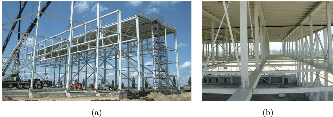
Abb. 2.7: Darstellung der Hangarkonstruktion im Bauzustand: (a) Einheben eines Fachwerkträgers, (b) Fachwerkträger im eingebauten Zustand (übernommen aus [71])
