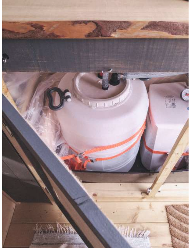
Abb.87: Frischwassertank und Warmwasserboiler im Küchenbereich.
