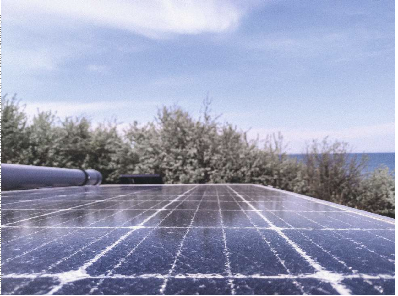
Abb.81: Solarpanel mit einer maximalen Leistung von 365 Watt. Durchschnittliche Produktion von 250 Watt an sonnigen Tagen im Mai.
