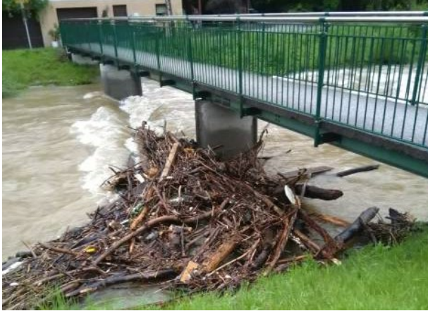
Abbildung 2: Verklauung am Hammerersteg in Bergheim (AT) (fischachbergheim, 22.05.2019)
