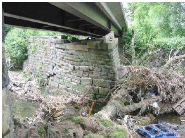
Abbildung 1: Teileinsturz des Mittelpfeiler an dem Lower Ashenbottom Viaduct, Lancashire, UK nach dem Hochwasser im Juni 2002 (Lamb et al., 2017)
