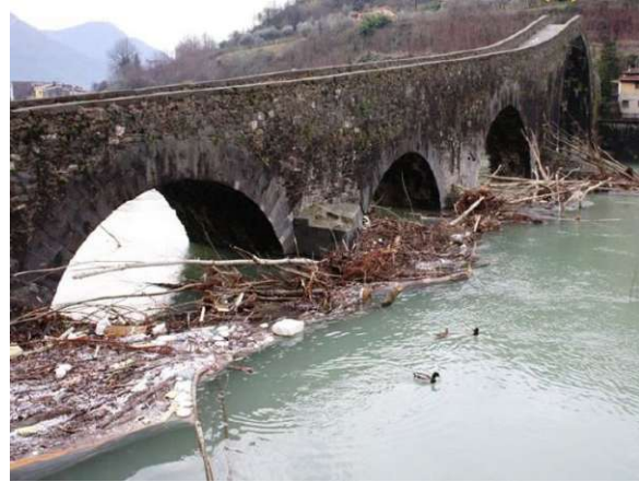
Abbildung 3: Verklauung an einer Brücke in Borgo a Mozzano (IT), 2014 (De Cicco et al., 2015)
