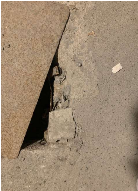
Abb. 2.5: Die Vorfunde von Zementbrocken im Keller.
