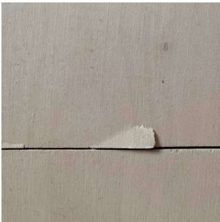
Abb. 2.13: Spalt im Türrahmen.
