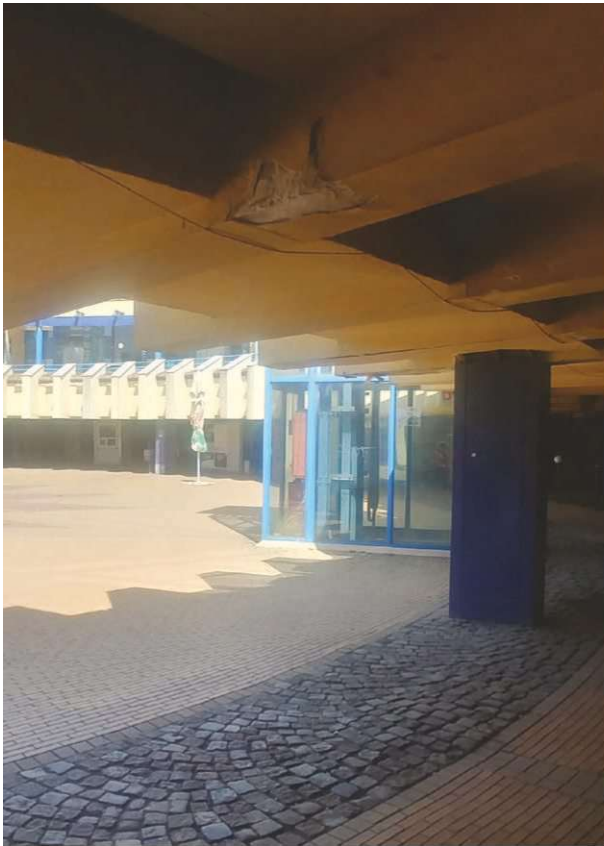
1. Zentraler Bereich der Rotunde mit Schäden am Tragwerk Abb. 84
