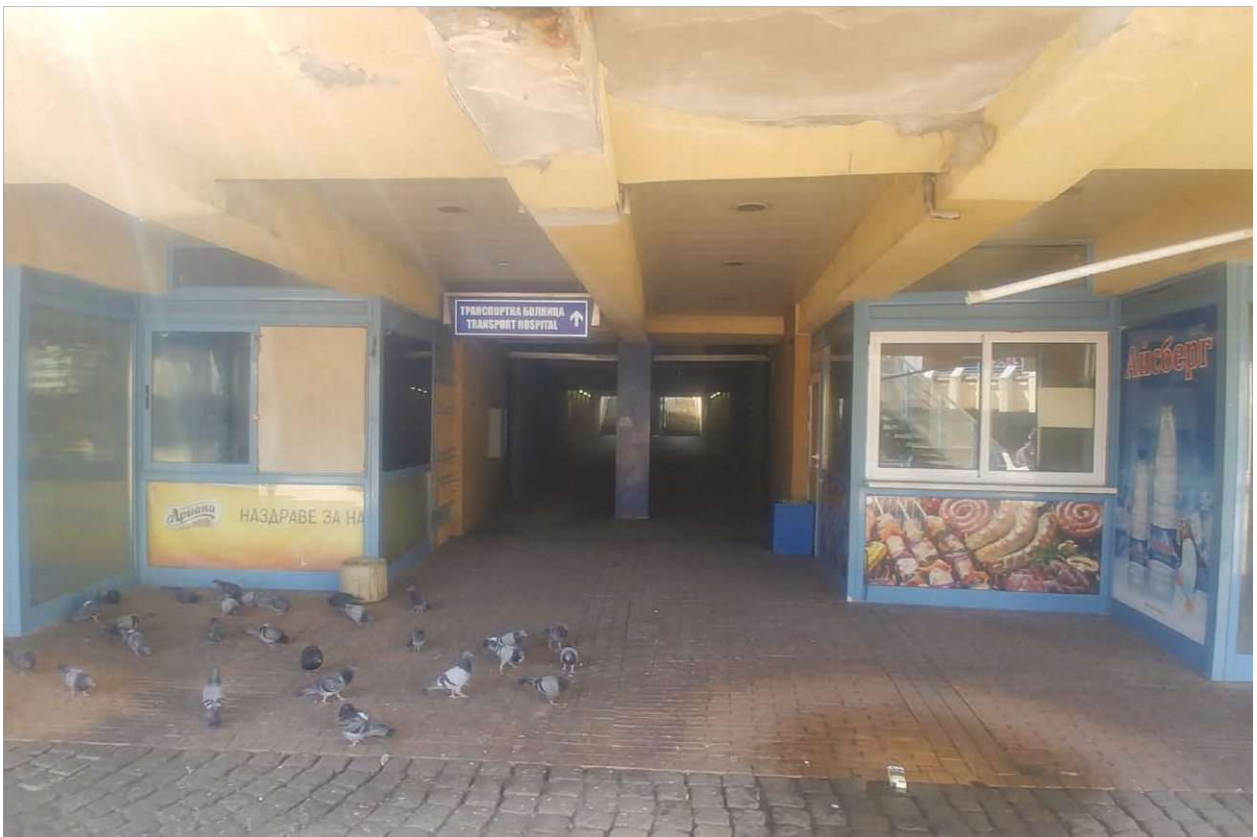
6. Dunkle Gänge und beschädigte Deckenuntersichten mit Wasserschäden Abb. 89
