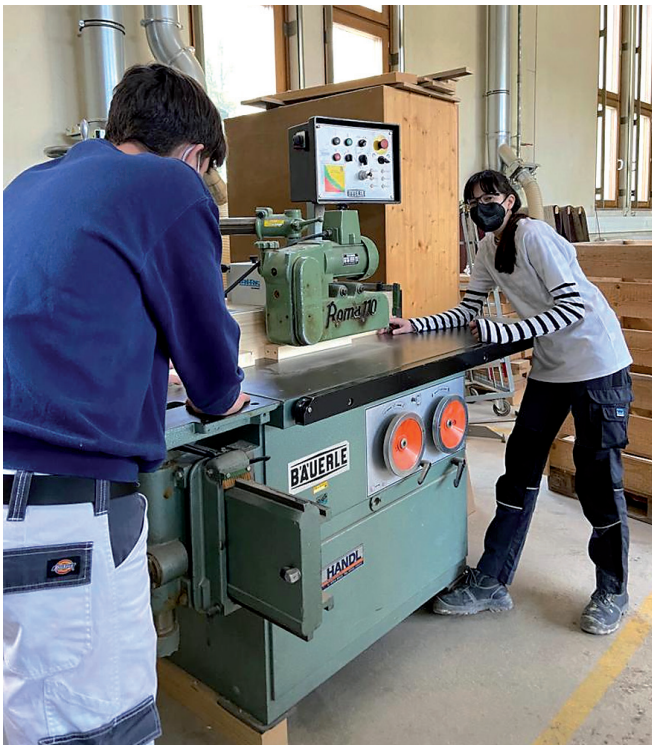
Schüler:innen des Camillo Sitte Bautechnikums beim Bau der im Rahmen des Forschungsprojekts MehrGrüneSchulen entwickelten Low-Cost-Begrünungssysteme.
