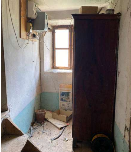
Abb. 25: Risse im Mauerwerk
