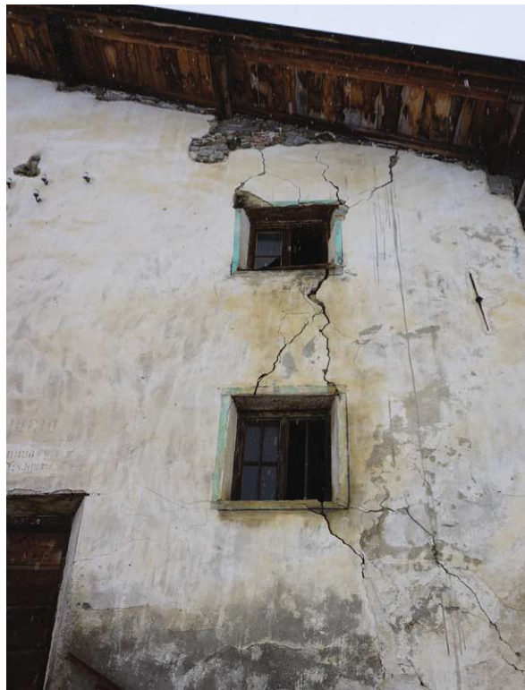
Abb. 2: Schäden im Steinmauerwerk
