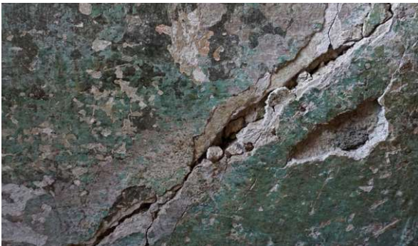
Abb. 10: Blick in die Mühle Abb. 11: Risse im Mauerwerk
