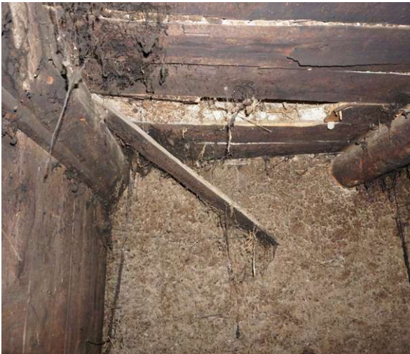
Abb. 31: Schäden in der Dachkonstruktion
