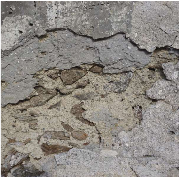
Abb. 10: Abbröckelnder Putz beim Hauptgebäude
