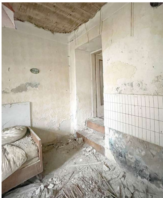
Abb. 127 Tür mit Stufen zum 18-Zimmer und beschädigte Decke
