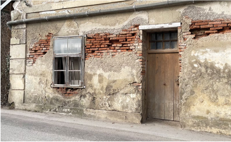
Abb. 48 Eingangstür und beschädigte Ziegelsteine
