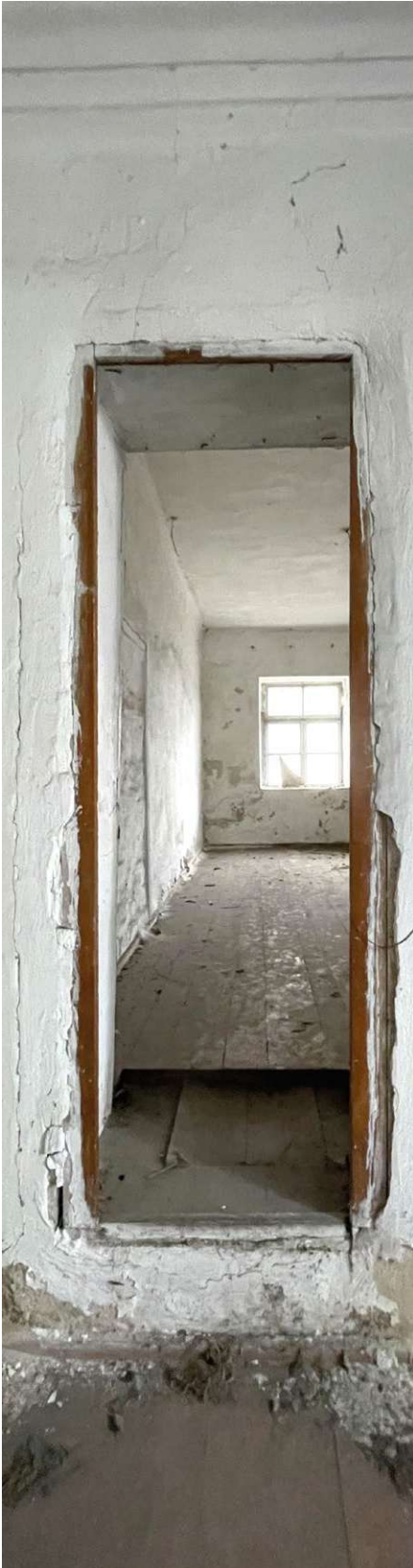
Abb. 115 Türöffnung und Höhenunterschied
