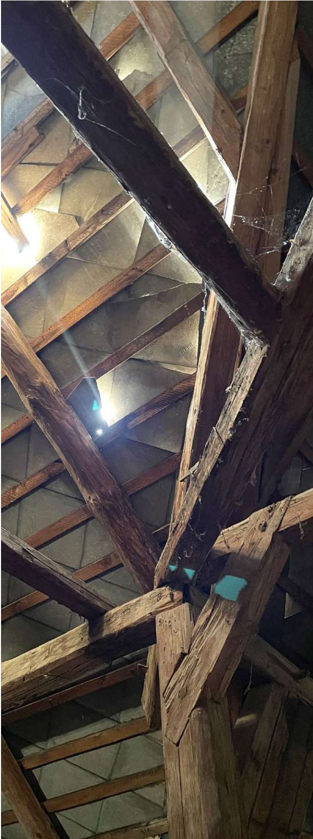
Abb. 173 undichtetes Dach - Sp. 8
