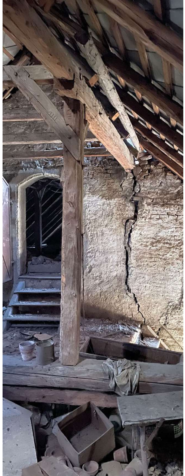
Abb. 172 Beschädigtes Mauerwerk - Sp. 7
