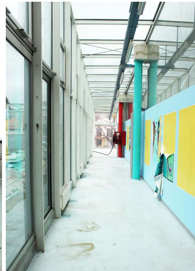
Abb. 303 Schneeeintritt durch geöffnete Schiebetür
