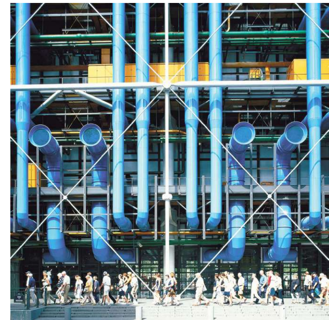
Abb. 41 Centre Pompidou, Paris 1977, Versorgungsschächte
