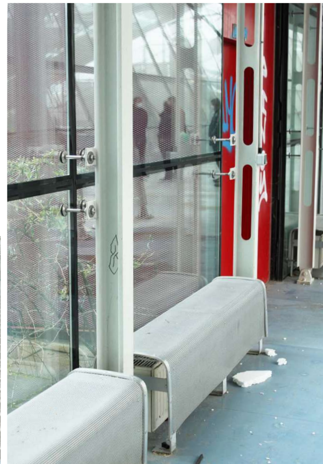
Abb. 152 Heizkörper mit Lochgitterverkleidung
