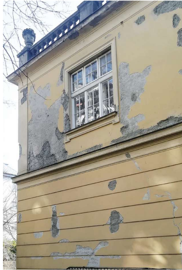
Abbildung 050: Putzschäden durch Verlegung der Terrasse, Nord-West Fassade.
