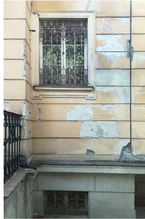
Abbildung 051: Putzschäden durch die Erweiterung des Raumes im Erdgeschoss.
