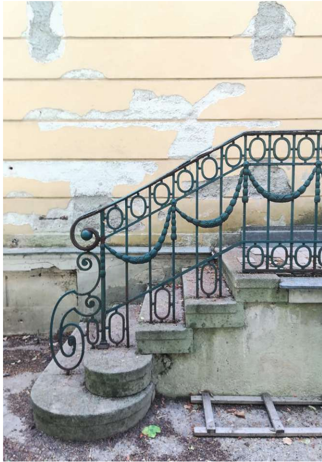
Abbildung 049: Putzschäden im Erdgeschossbereich der Nord-West Fassade.
