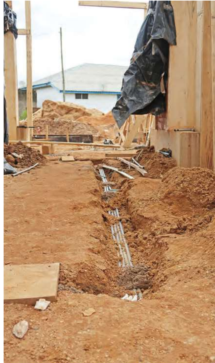
Abb. 181: Netzanschluss fig. 181: mains connection
