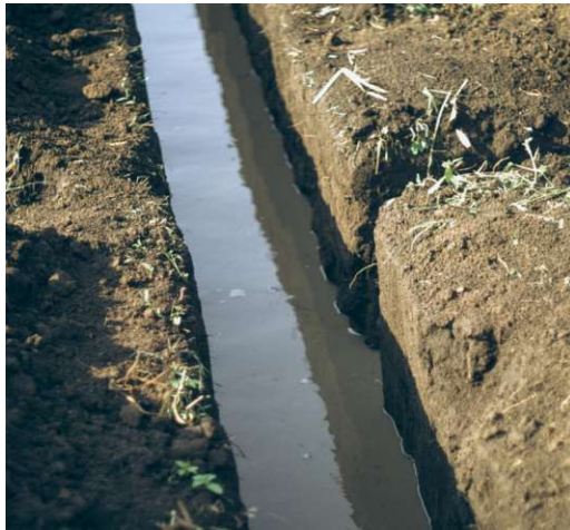
Abb. 80: Baugrube steht unter Wasser
