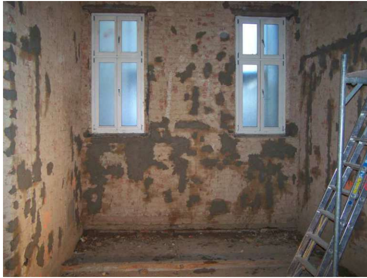
Abb 26: Schließen von Schlitzen und Fehlstellen im bestehenden Mauerwerk vor Aufbringen des Putzes
