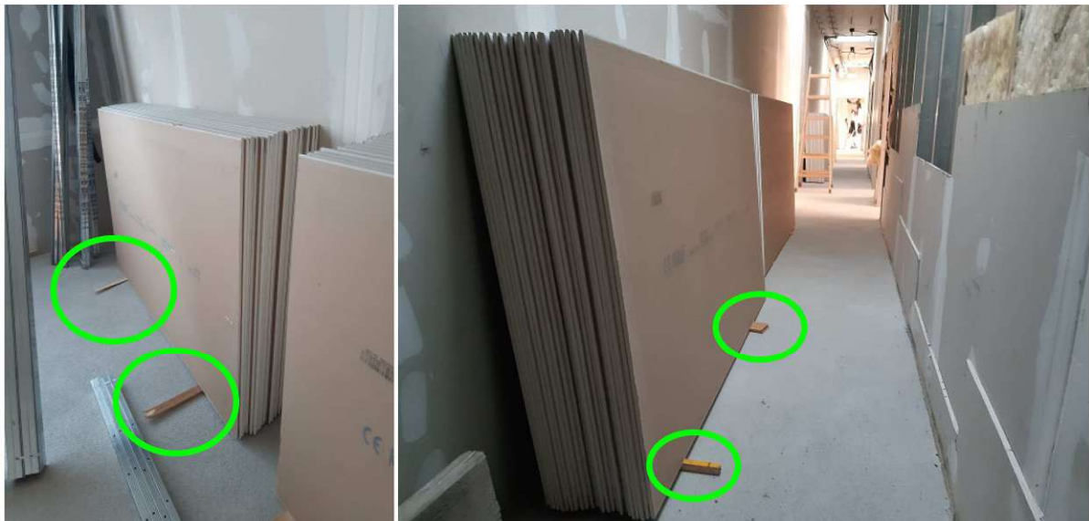
Abb 30: Durch die Lagerung von Baumaterial auf nicht vollständig ausgehärtetem Estrich kann es zu Rissbildung kommen. Die hier in grün gekennzeichnete, punktuelle Einleitung der Lasten konzentriert die Lasten weiter
