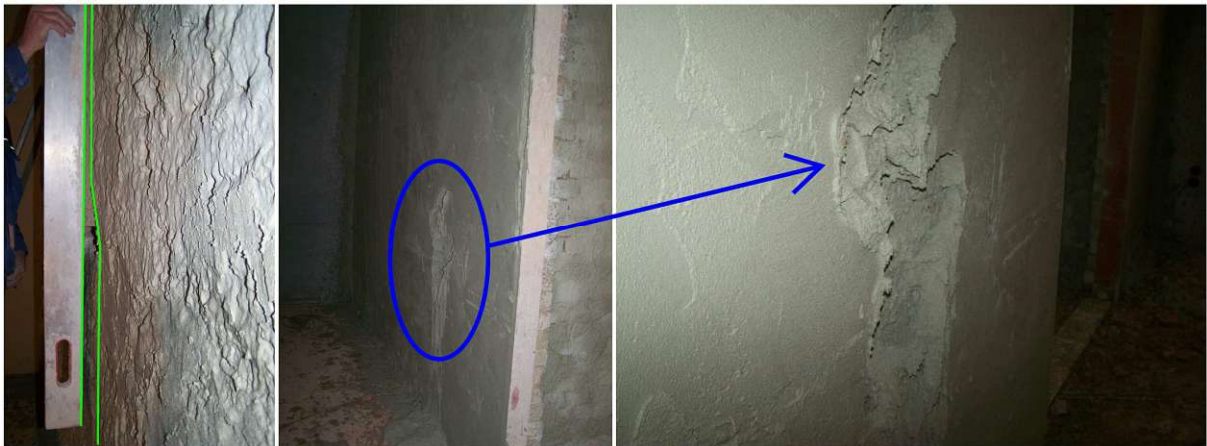
Abb 29: Überschreiten der zulässigen Putzdicke führt zu absacken des Putzes und Rissbildung. Zur leichteren Kenntlichkeit der Unebenheiten wurde die Wandoberfläche in grün gekennzeichnet
