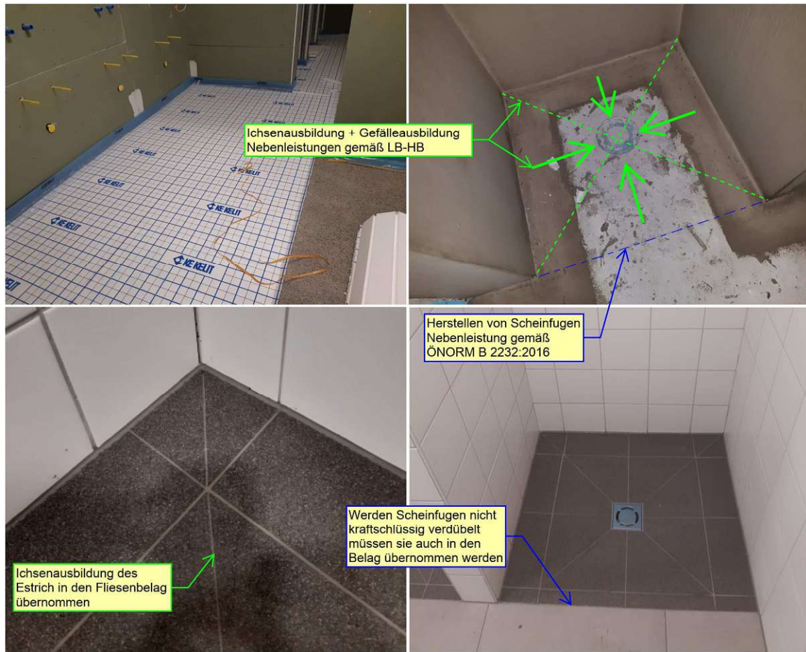
Abb 31: Herstellen eines schwimmenden Estrichs. In der Abbildung sind alle Arbeitsschritte von der Aufbringung der Schüttung, Verlegen der Trittschalldämmung und Dampfbremse, Estricheinbau mit Gefälleausbildung, sowie Verbundabdichtung und Flieseneinbau ersichtlich
