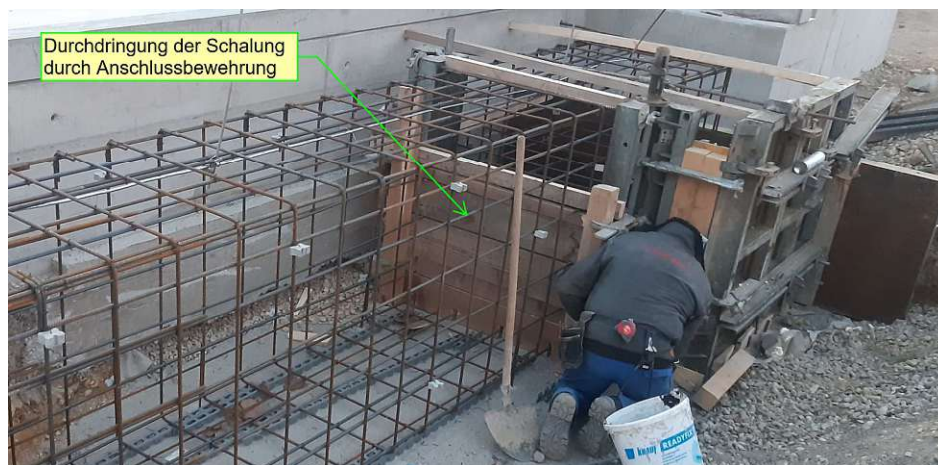
Abb 21: Durchdringungen der Schalung durch Bewehrungsseisen. Jeder Bewehrungsstab muss einzeln ausgespart werden.
