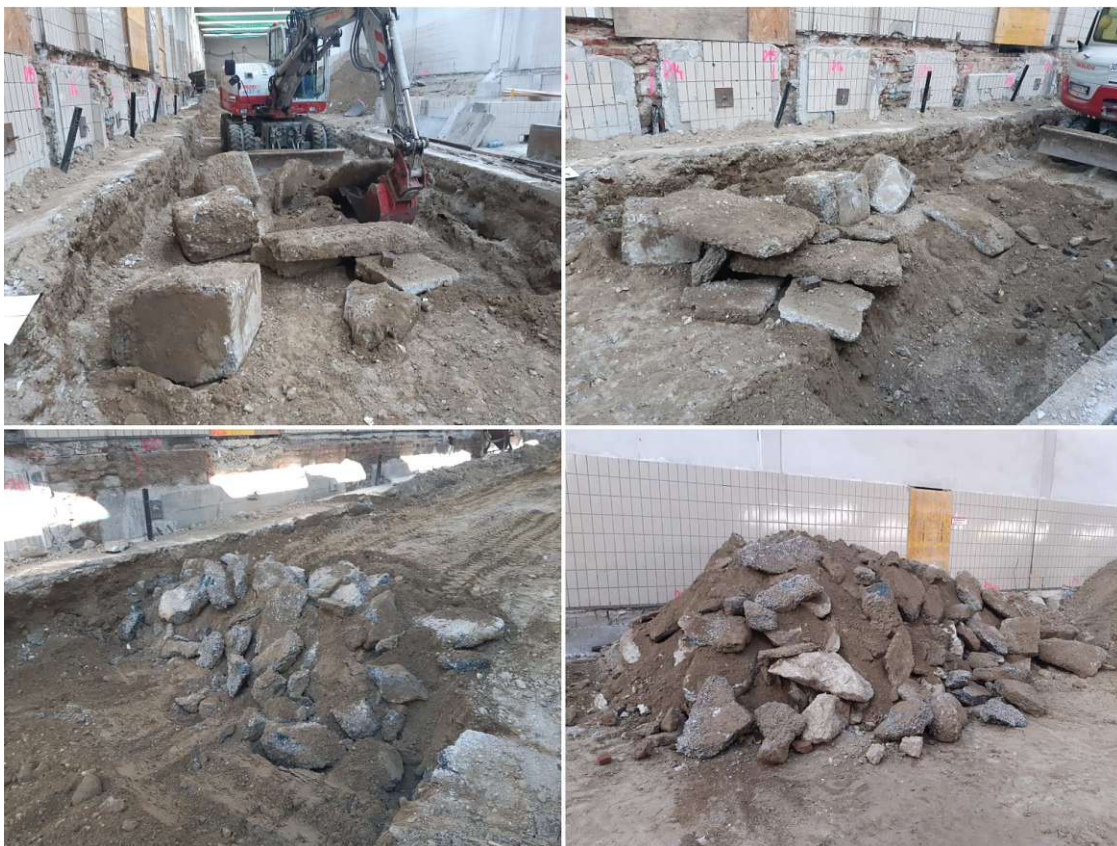
Abb 14: Einzelhindernisse im Aushub – oft nur mittels Abrechnungsvereinbarung beherrschbar
