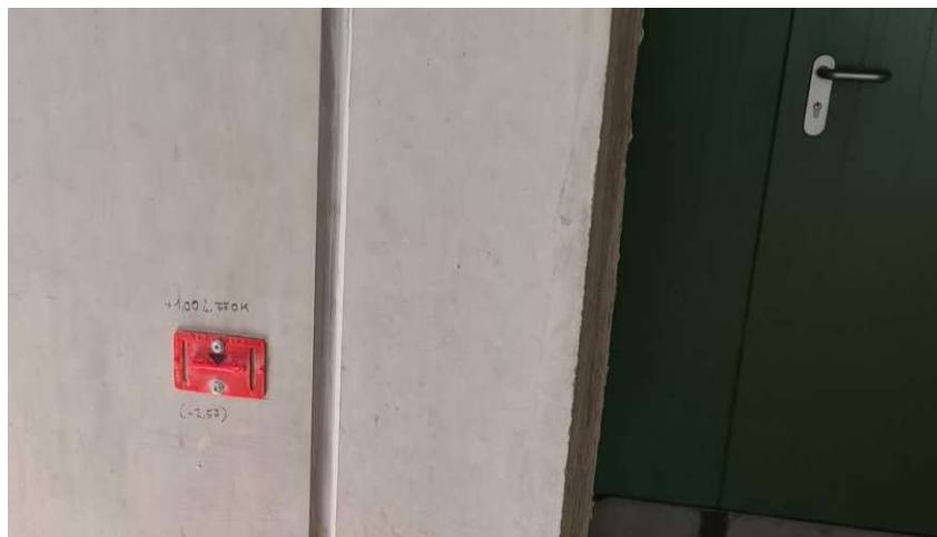
Abb 8: Eindeutig erkennbarer Meterriss
