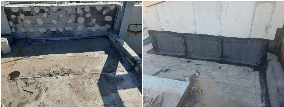
Abb 34: Durch Bohr- und Schneidearbeiten wurde die bestehende Abdichtung durch Betonschlamm verschmutzt (links). Nach Trocknung wurde dieser abgekehrt und die Haftung mittels Voranstrich sichergestellt. (rechts)
