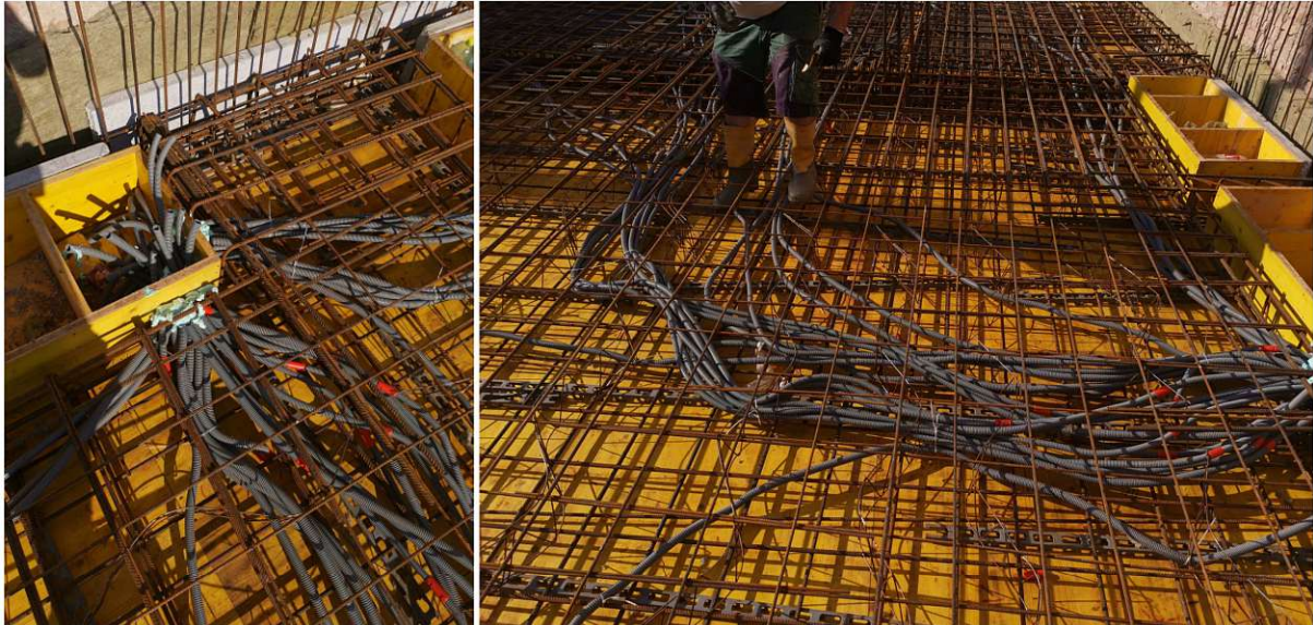
Abb 22: Leerrohre in Beton – Behinderung der Bewehrungs- und Betonarbeiten
