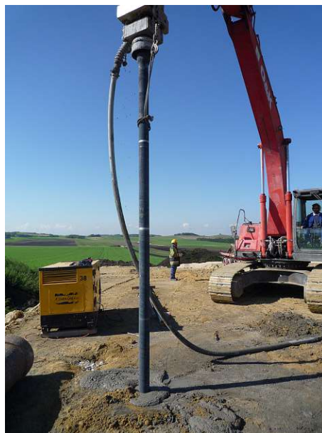
Abb. 4.20: Einrammen der einzelnen Rohrsegmente des Projektstandorts HA3 in Hagen (Foto: KELLER GRUNDBAU GES.MBH.)
