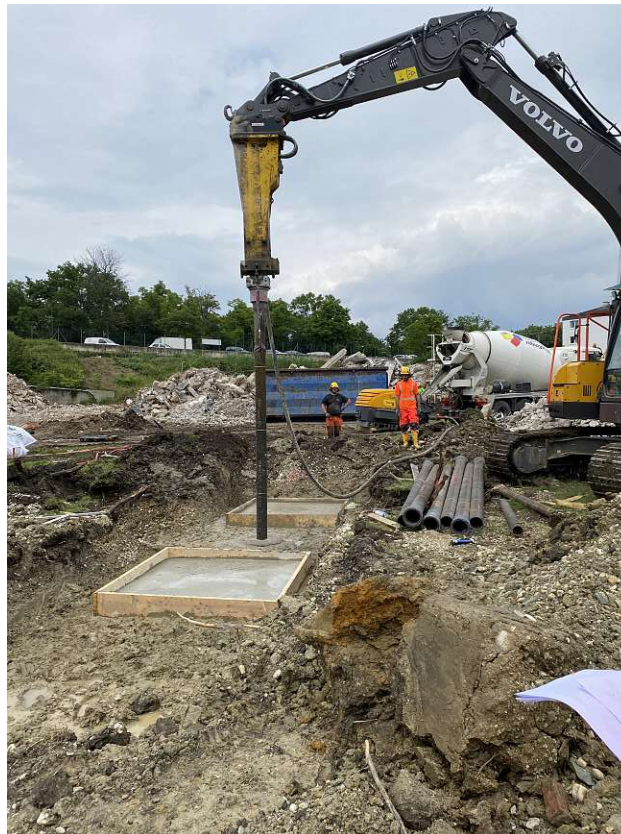
Abb. 4.41: Einrammen des Pfahles und Ausschalen der Fundamente des Projektstandortes Brunn am Gebirge
