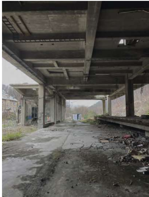
Überdachte Verladerampe und Verladeanlage 2
