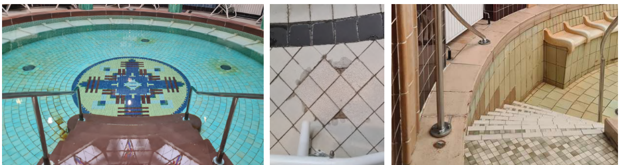
Abb. 180: Verfärbungen und abgenutzte Stufenkanten (links), ausgetauschte Bodenfliesen und Schäden (Mitte) und Verfärbungen, ausgetauschte Fliesen und Schäden am Rand (rechts) 2023
