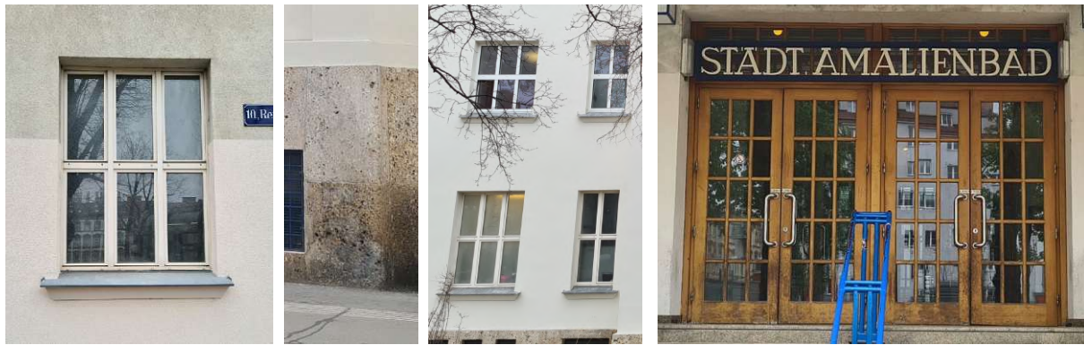
Abb. 182: Fenster und Fassade vor der Sanierung, Kellerplatten mit Witterungsspuren, ältere und neuere Fenster an der Südfassade und Eingangstüren (von links nach rechts) 2023
