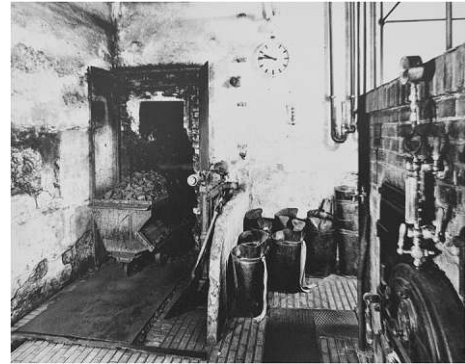
Abb. 123: Kohlewaggon im Kesselhaus 1926
