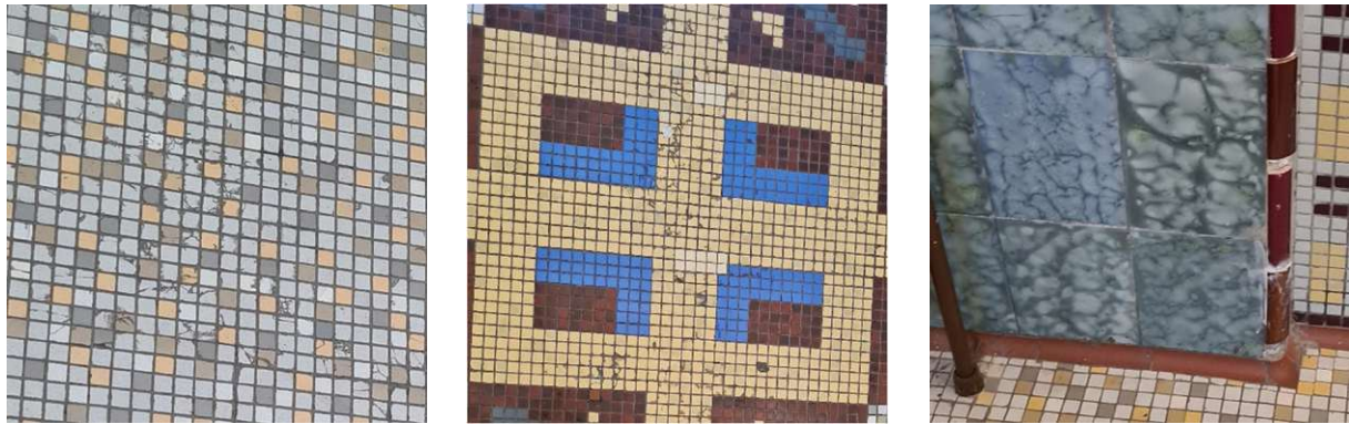
Abb. 179: Risse am Boden (links), Beschädigungen, ausgetauschte Elemente mit farblichen Unterschieden (Mitte) und Schaden an einer Kante und Wandfliese mit anderem Farbton (rechts) 2023
