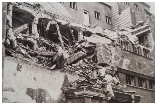
Abb. 42: Zerstörungen an der Nordseite (oben), Ostfassade (Mitte) und Abplatzungen und zerstörte Skulptur an der Nordfassade (unten)
