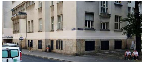
Abb. 52: Vordere Ecke der Nordfassade mit Graffitis 2018 (oben) und nach der Beseitigung dieser 2019 (unten)
