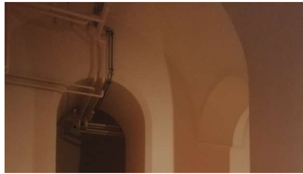
Abb. 202: Leitungsführung in der Unterkirche am Übergang zur Apsis eigene Aufnahme 02.12.2022
