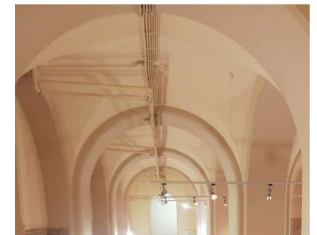
Abb. 201: Leitungsführung in der Unterkirche eigene Aufnahme 29.06.2022
