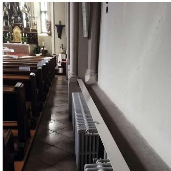
Abb. 204: Oberkirche: Heizkörper und Lautsprecher ohne sichtbare Leitungsführung eigene Aufnahme 31.03.2022
