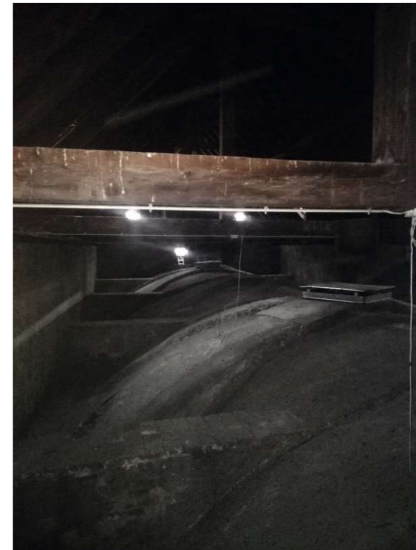
Abb. 141: Gewölbe mit Abdeckung über den Durchbrüchen, Verstärkung über den Rippen eigene Aufnahme 02.12.2022
