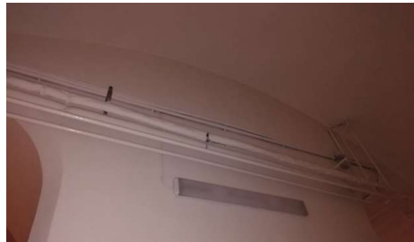
Abb. 203: Leitungsführung der Unterkirche im Apsisbereich eigene Aufnahme 02.12.2022
