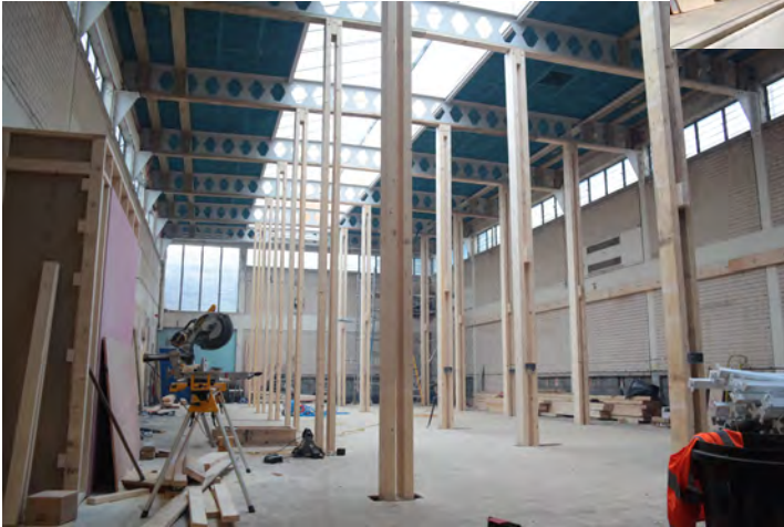
A.68 Über dem abgedeckten Becken wird die Grundstruktur für die flexibel gestaltbaren Studios errichtet (Assemble)
