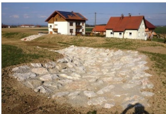
Abbildung 48: Gesicherter Einlauf. (Quelle: Land OÖ)
