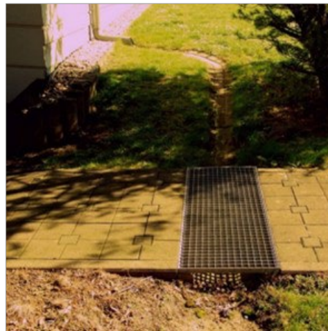
Abbildung 32: Maßnahme zur Ableitung und Retention von Oberflächenwasser. (Quelle: INFRASTRUKTUR & UMWELT o. J. a: o. S.)
