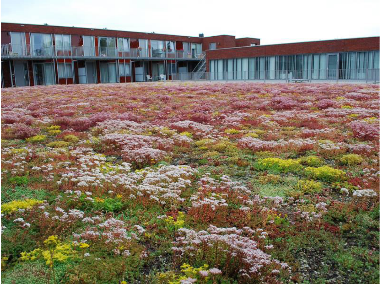
Abb.101: Beispiel einer extensiven Dachbegrünung
