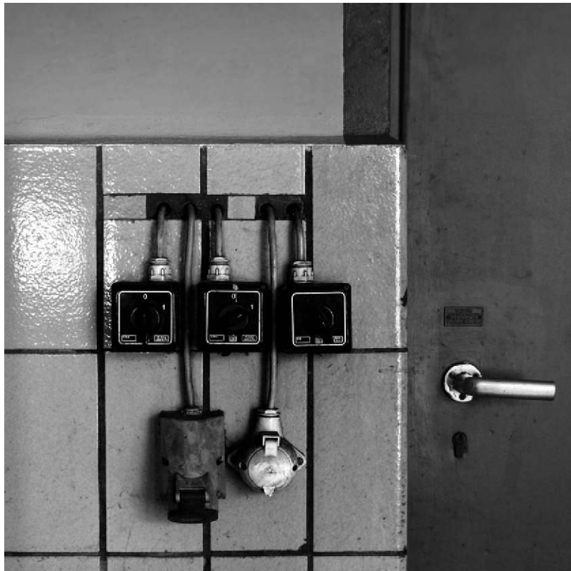
Interieur des Heizkraftwerk
