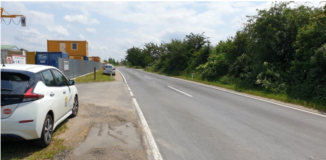
Abb. 4.4: Asphaltfahrbahn vor dem Fräsvorgang (Eberhardtsteiner, et al., 2020)
