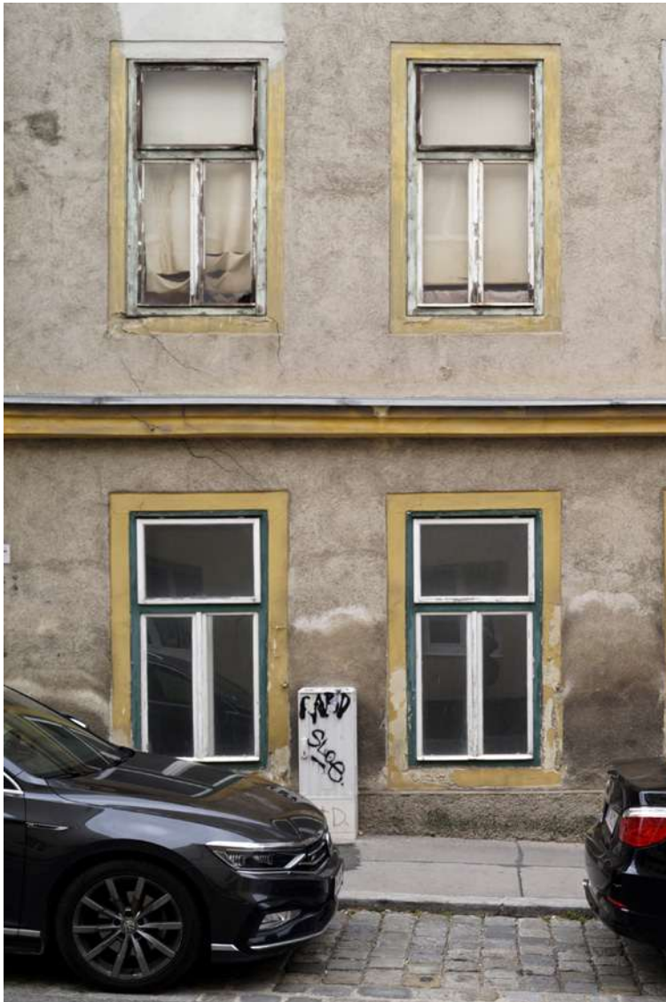
Abb. 2 Leerstand - Haus im 12. Bezirk eigene Aufnahme Hier rührt sich bereits seit mindestens zwei Jahren nichts. Sowohl das Erdgeschoss, wie auch ein Großteil der oberen Geschosse steht leer.
