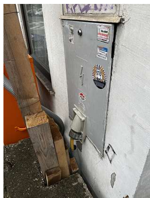
(a) Huckepackhausanschluss für die Baustelle
