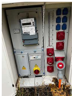
Abb. 3.17: Anschlussverteilerkasten der Baustelleneinrichtung
