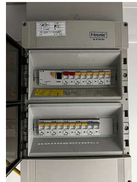
(d) AP-Verteiler im Sanitärcontainer
