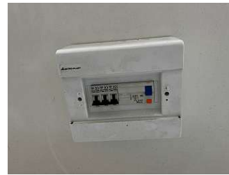
(b) AP-Verteiler Deckenuntersicht
