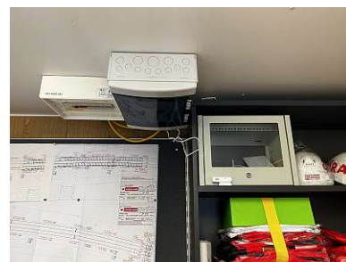
(b) V.l.n.r AP, Verteiler (Bestand), Messverteiler, Serverschrank
