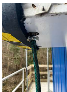
(b) Kondensatabfluss bei Kompaktklimagerät
