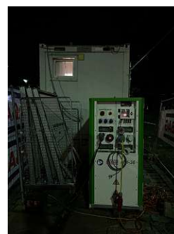
(b) Batterie mit 36 kWh Speicherkapazität
