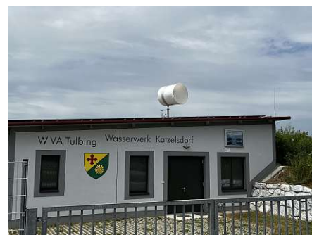
(b) Kleinwindkraftwerk am Dach
