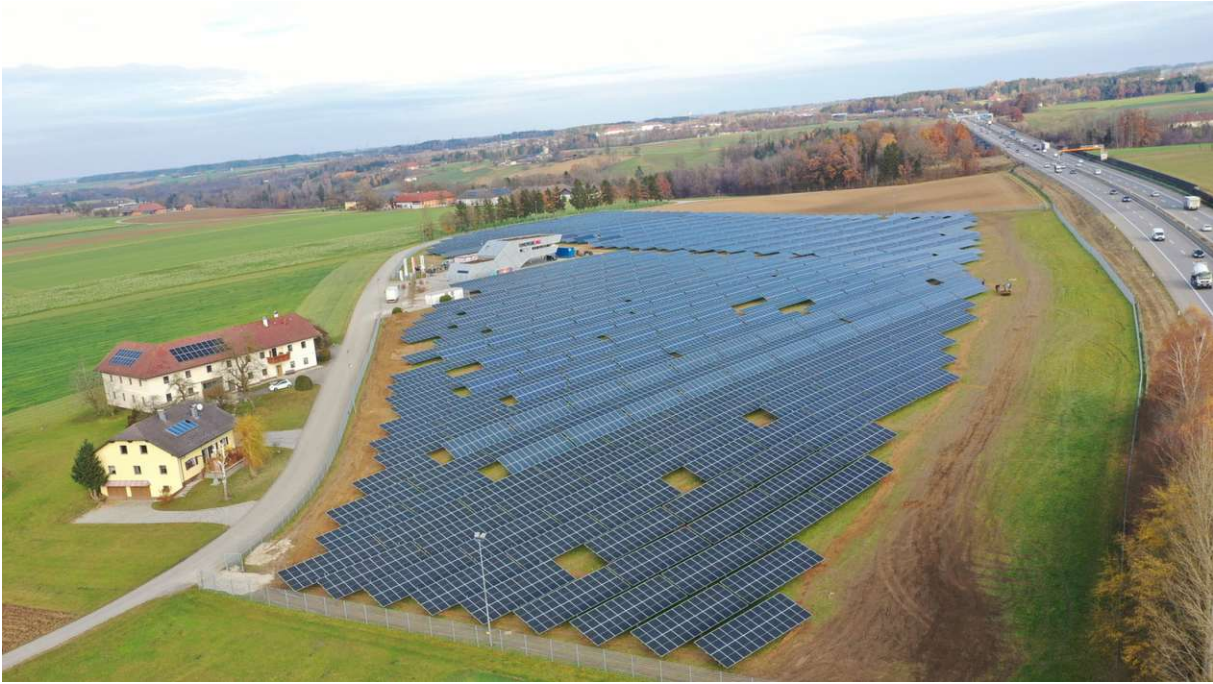
Abb. 9: Photovoltaikanlagen in Eberstalzell (OÖ); Quelle: EnergieAG
