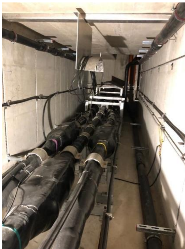
Abbildung 3-4: Muffe (380 kV) in Muffenbauwerk mit Auskreuzung der Phasen
