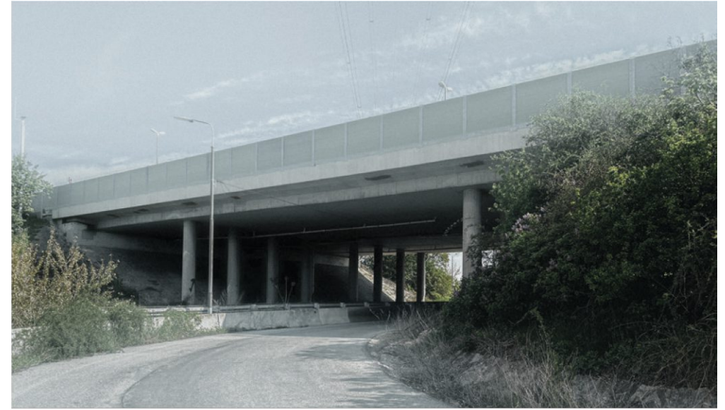
55 — Hochrangige Verkehrsinfrastrukturen prägen die Umgebung – hier im Bild ist eine Unterführung der Autobahn A4 direkt am nördlichen Rand des Areals. Eigene Aufnahme, 2023.
