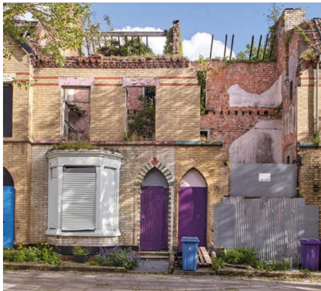
35 — Ein verfallenes Gebäude der Cairns Street. © Assemble Studio
