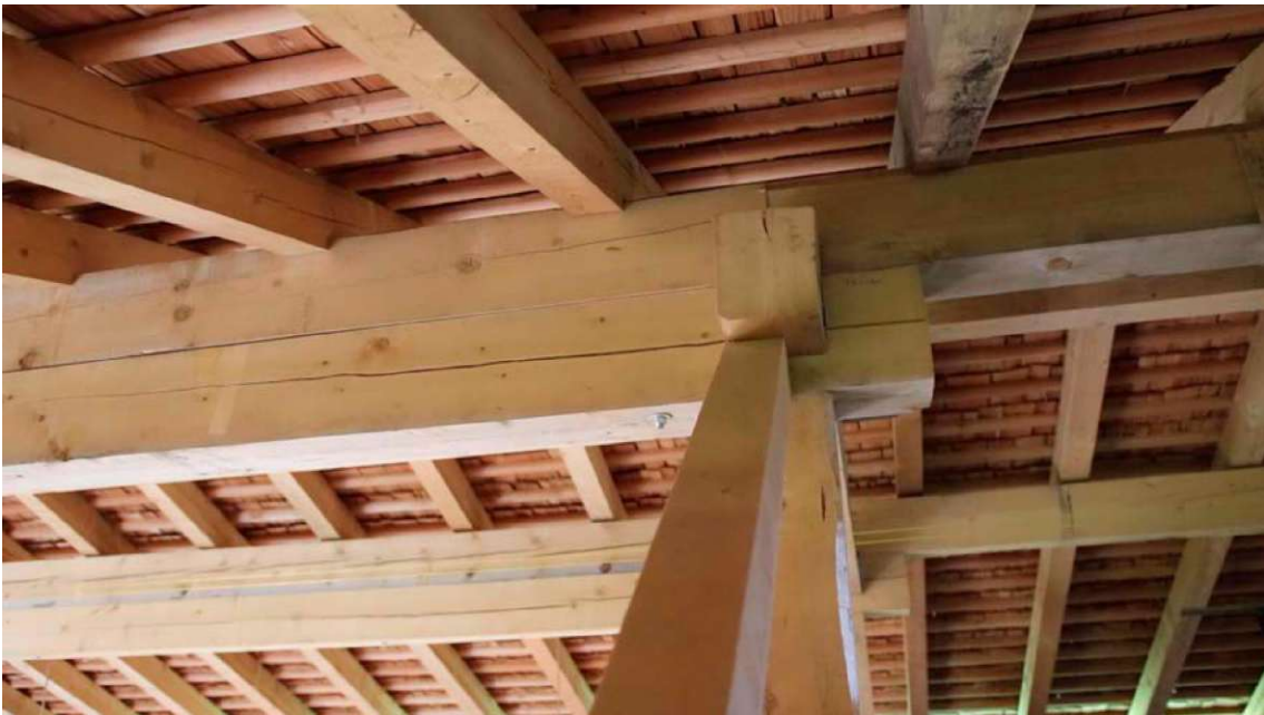
Abb. 4.6 (oben): Dreifach stehender Pfettendachstuhl direkt über der Galerie / Abb. 4.7 (unten): Knotenpunkt Mittelpfette auf Stütze mit Strebe
