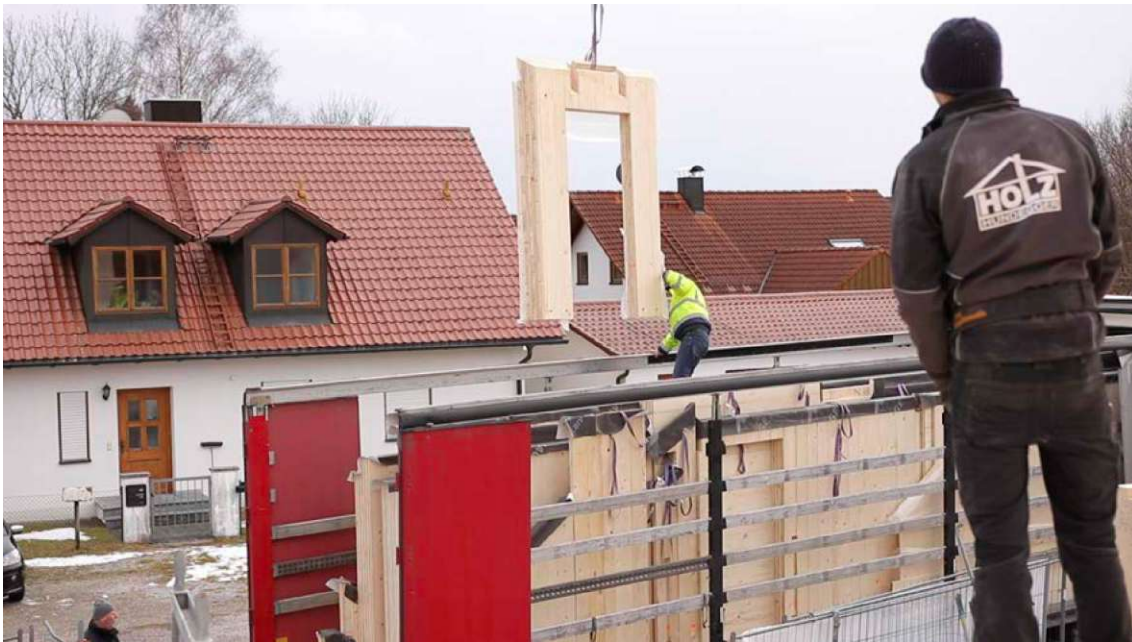
Abb. 3.8: Wandelement mit vorbereiteter Türöffnung wird vom LKW direkt an den Einbauort gehoben
