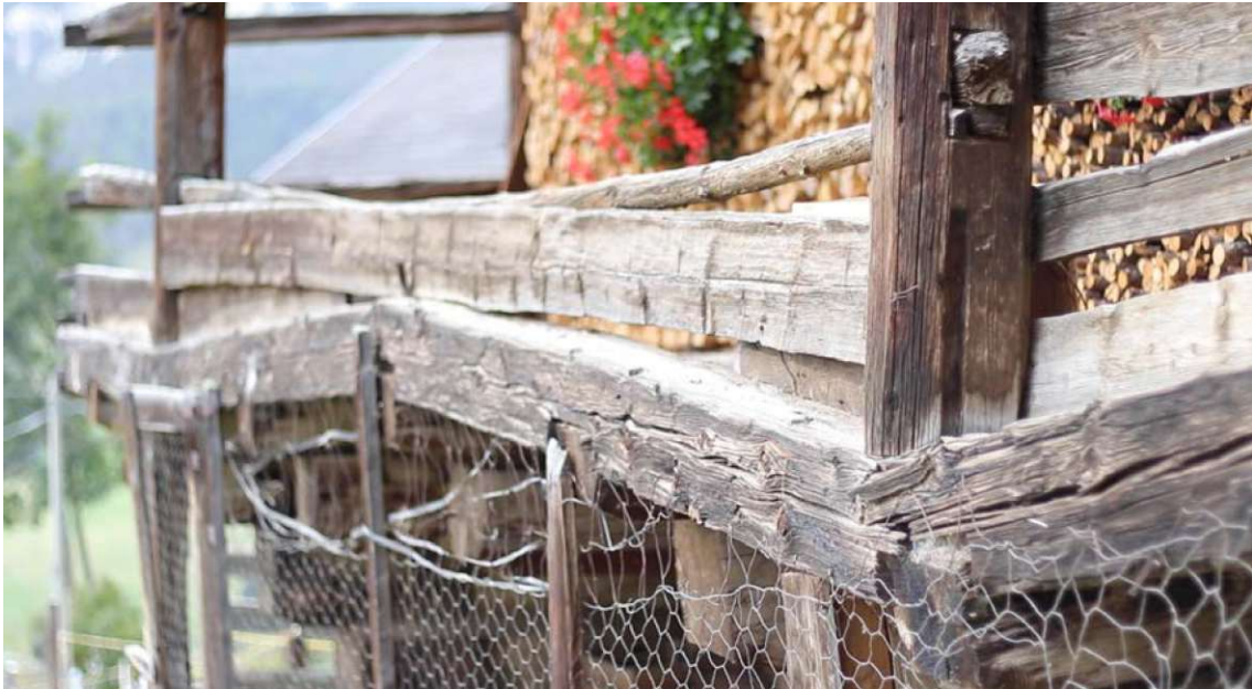
Abb. 1.11: durch Druck der Stützen verformter Balken am umlaufenden Solder
