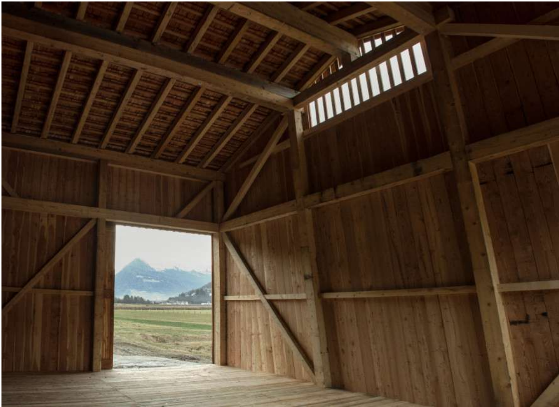
Abb. 4.2 (oben): Nord-West-Ansicht des Stadels; Foto: Matthias Delueg / Abb. 4.3 (unten): Eingangstor mit Blick nach Westen; Foto: Matthias Delueg
