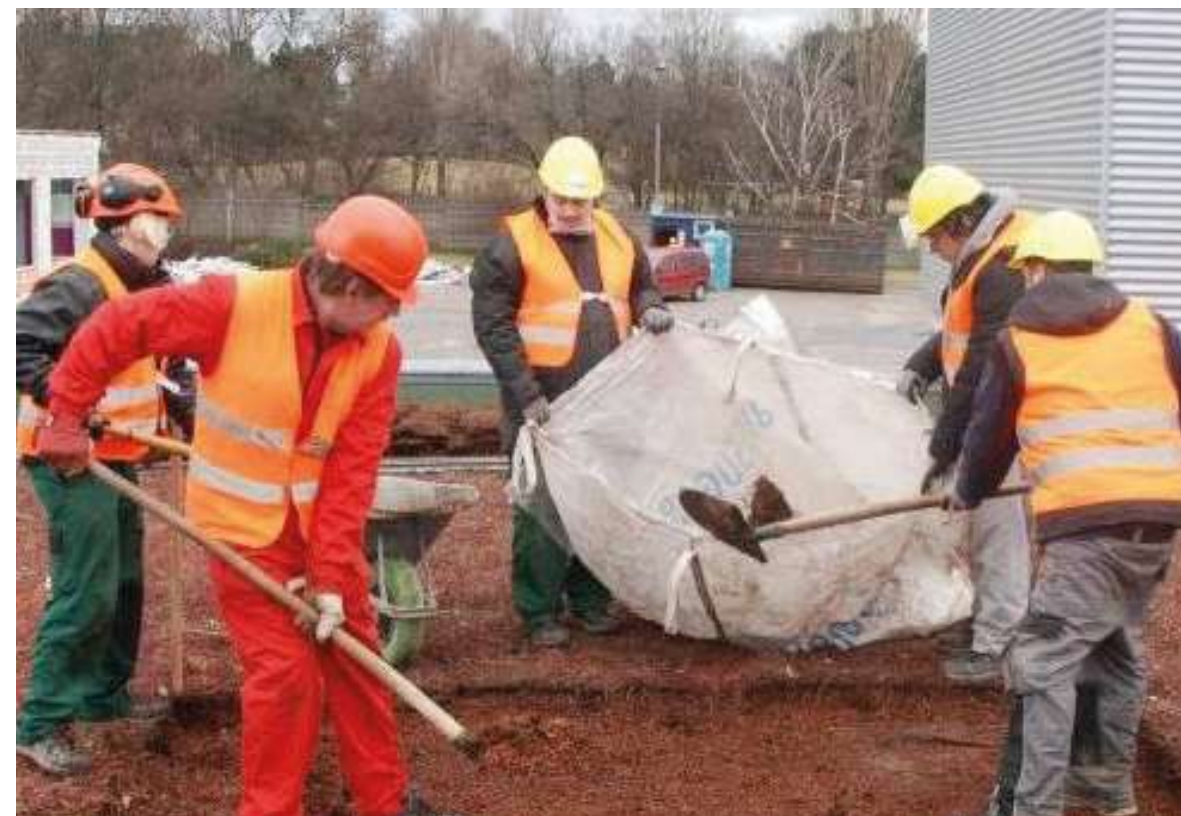
Abb 77: Rückbau des Dachsubstrates, händisch durchgeführt mit Schaufeln und Big Bags. Es wurden von den Dachflächen auch die Dämmplatten durch den Wiedereinsatz in das neue Projekt vor Ort vor der Entsorgung bewahrt.
