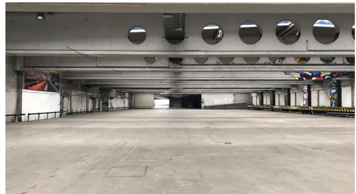
Abb 26: PVZ KGP Standplätze 1 Obergeschoss, Blick Richtung Paketzustellung, © Magdalena Klaus
