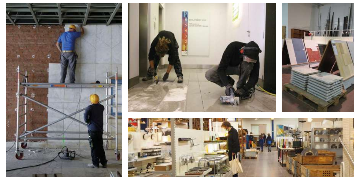
Abb 86 - 89: Rückbau von Wand- und Bodenbelägen aus Naturstein, rückgebaut von dem Belgischen Rückbauunternehmen Rotor Deconstruction. Die Materialien können über den Webshop von Rotor DC gekauft werden, vor Ort im Shop stehen diese zur Besichtigung bereit. Quelle: https://www.rotordb.org/en/projects/rotor-dc-reuse-made-easy , Zugriff 29.8.21
