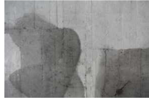
Schäden durch Brandbelastung im Deckenbereich
