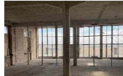
Provisorisches Front aus Plexiglas und Holzrahmen
