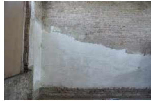
Abblättern der Putzoberfläche
