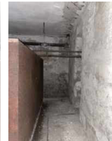
Rohrleitungen vom Tank ins Freie
