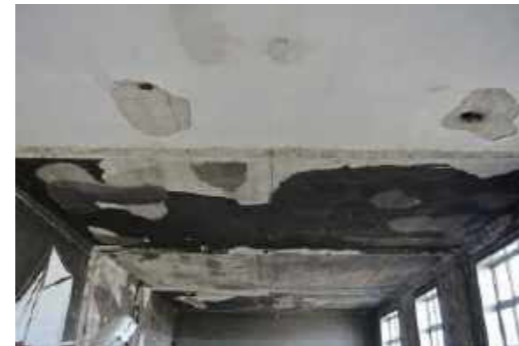
Schäden durch Brandbelastung im Deckenbereich
