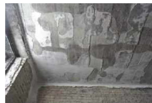
Schäden durch Brandbelastung im Deckenbereich
