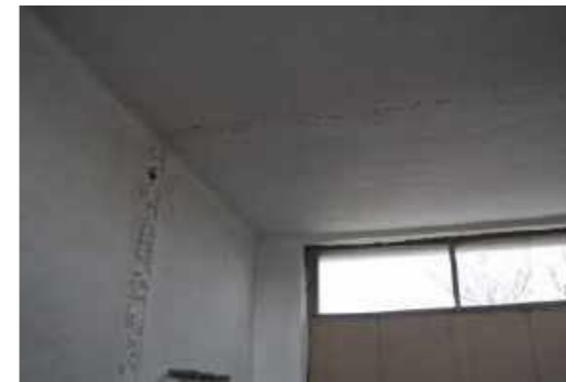
Spuren ehemaliger Trennwände
