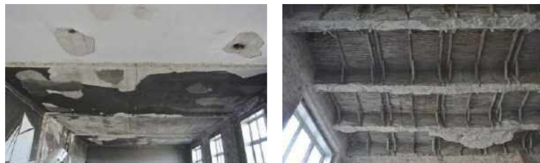
Abb. 283-284 Beeinträchtigung der Tragfähigkeit von Hohlkammerdecken infolge der Brandbelastung
