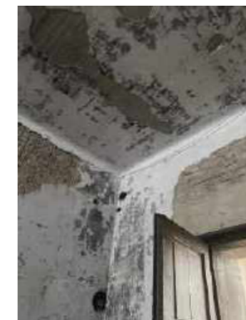
Abblättern der Putzoberflächen
