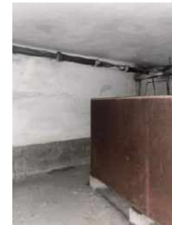
Öltank auf Streifenfundament
