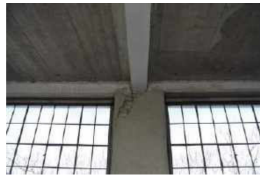
Sichtbare Rissbildung in der Tragstruktur
