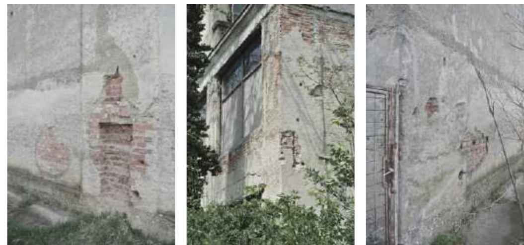
Abb. 324-326 Exemplarische Putzschäden an der Fassade
