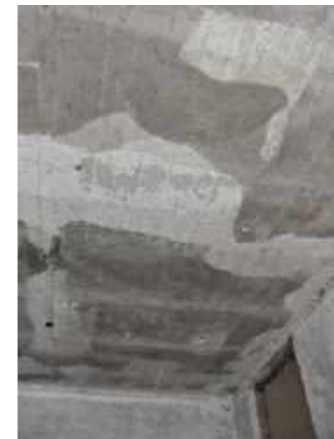
Brandschäden im Deckenbereich
