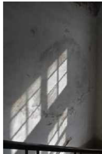
Abnutzungsspuren am Putz
