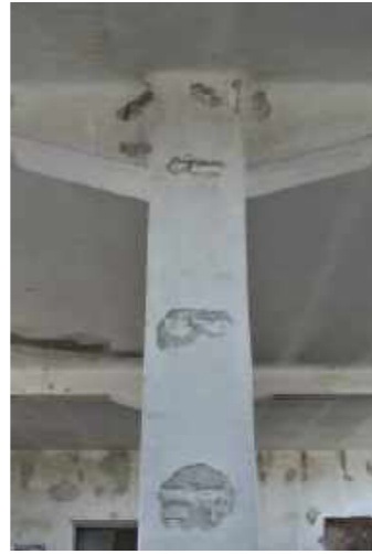
Abnutzungen an Putzoberflächen
