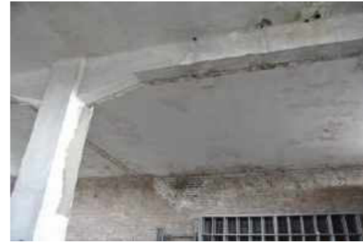
Wasserschäden unter der Terrasse und Sichtziegel
