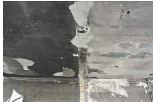
Schäden durch Brandbelastung im Deckenbereich
