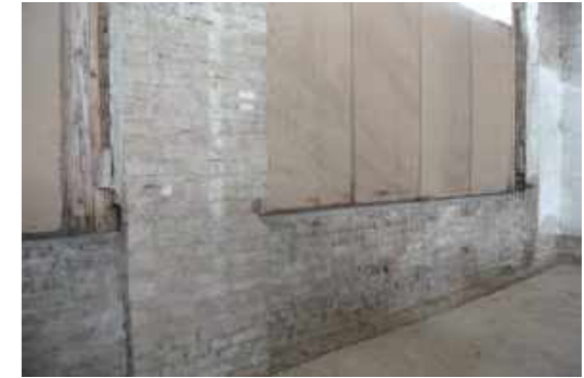
Ausbetonierte Fensterbänke und Fensterprovisorien
