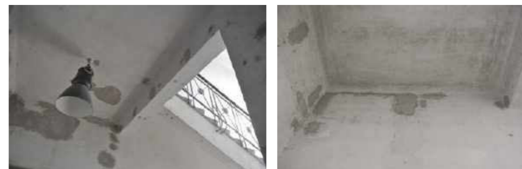
Abb. 308-309 Verunreinigungen und Schäden an den Putzoberflächen im Gebäude
