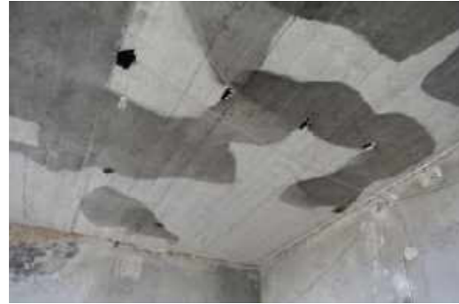
Schäden durch Brandbelastung im Deckenbereich
