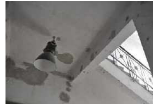
Abnutzungsspuren und Ausbesserungsarbeiten
