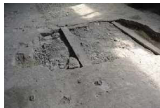
Schäden/Unebenheiten im Bodenbereich
