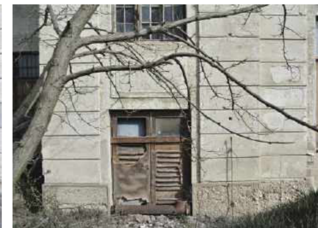
Abb. 226 Südliche Zutrittsmöglichkeit in desolatem Zustand
