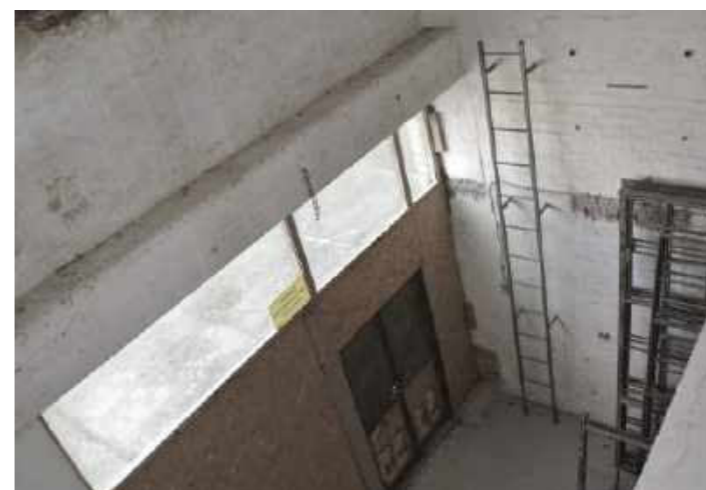
Einblick in den Traforaum vom Obergeschoss
