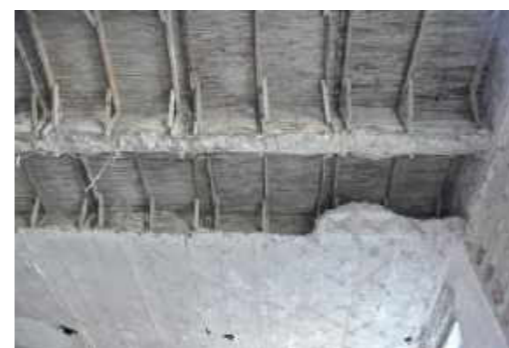
Baufällige Deckenuntersicht durch Brandschäden
