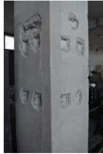
Abnutzungsspuren in Stützen
