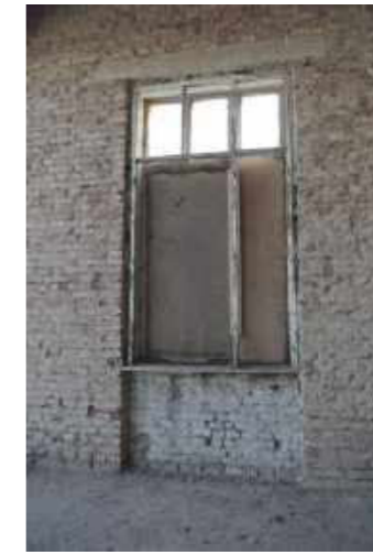
Bauzeitliches Fensterelement Süd
