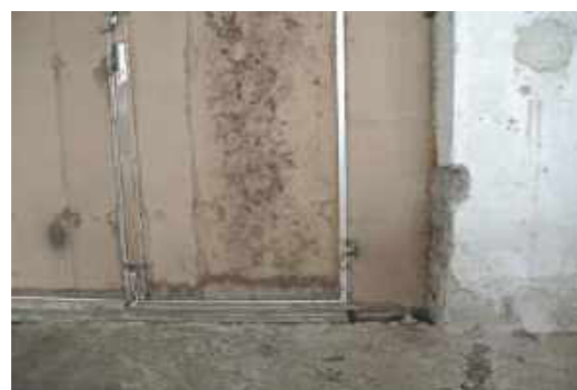
Provisorisches Einfahrtstor innen/Bodenunebenheiten
