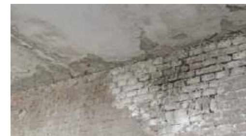
Abb. 285 Wasserschäden unter der Terrasse
