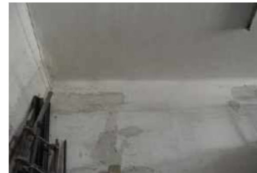
Putzschäden an den Wänden
