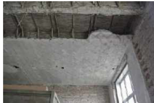
Baufällige Deckenuntersicht durch Brandschäden
