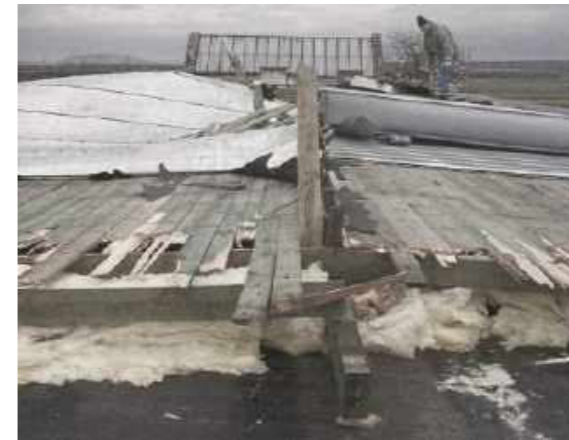
Abb. 206 Fotografische Dokumentation der Sturmschäden
