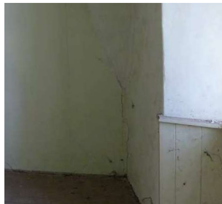
Abb. 143: Risse an Gewölben
