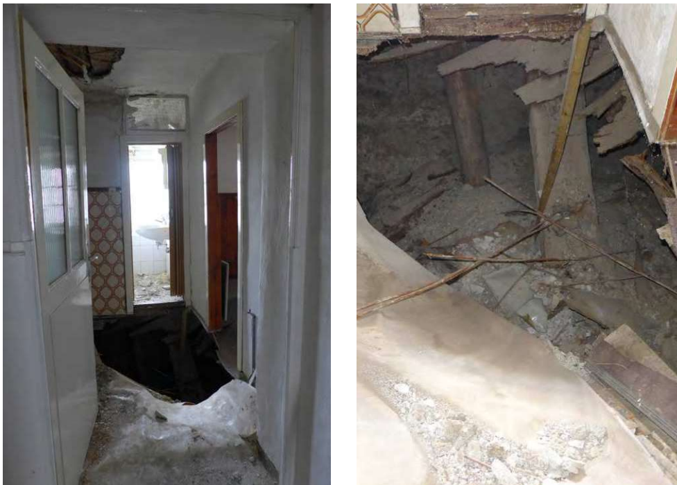
Abb. 113: Raum H.1.04a mit eingestürzten Boden (li.) und Bodenaufbau (re.)
