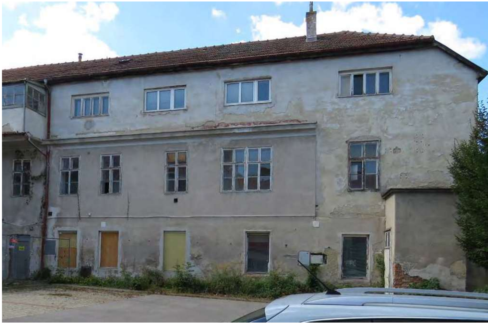
Abb. 116: Putzschäden der Südfassade des Nebentraktes
